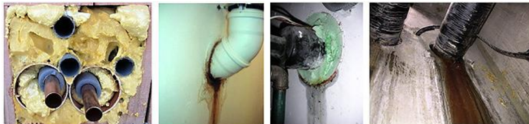
Obr. 1 Nevhodné těsnění prostupu PUR pěnou a protékání vody do objektu
