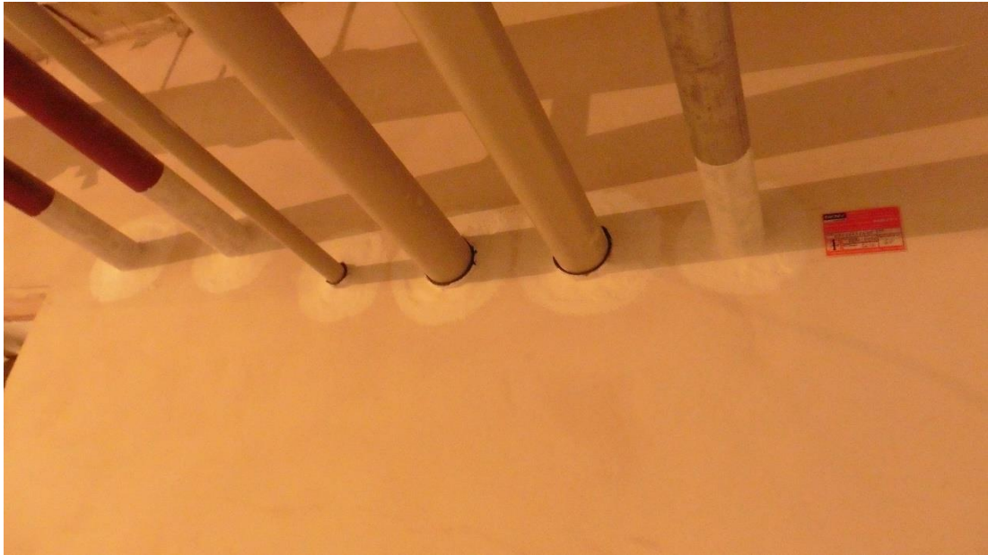
Obr. 65 Kobylice - Nehořlavá potrubí jsou opatřena protipožárním nátěrem, hořlavá zpěňujícími pásy
