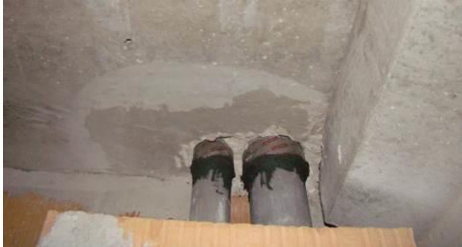
Obr. 52 Chybí kovová objímka kolem zpěňujícího těsnícího pásku
