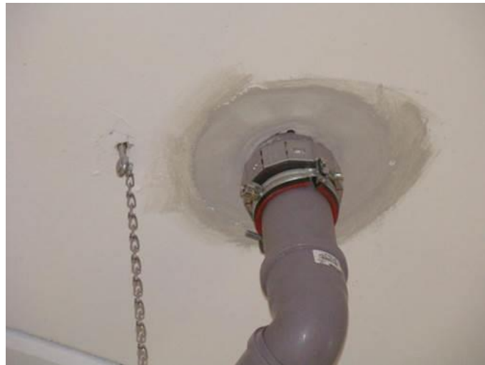
Obr. 53 Objímka manžety není připevněna k požárně dělící konstrukci
