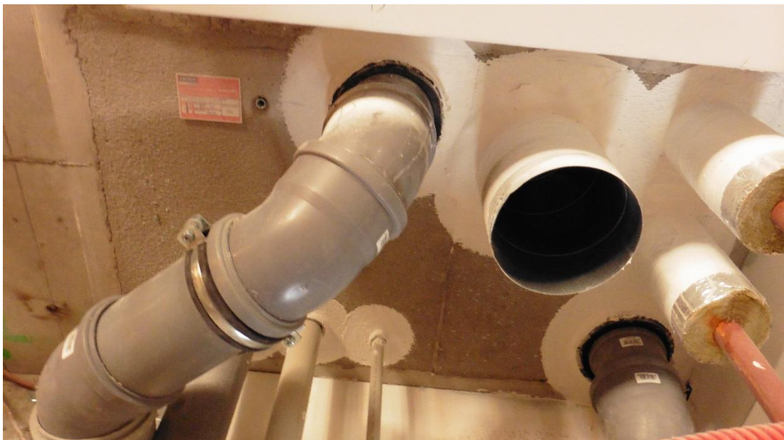
Obr. 66 Kobylice – Použití zpěňujícího pásu na plastovém potrubí, protipožárního nátěru na vzduchovodu a kombinace protipožárního nátěru a tepelné izolace na rozvodech topení
