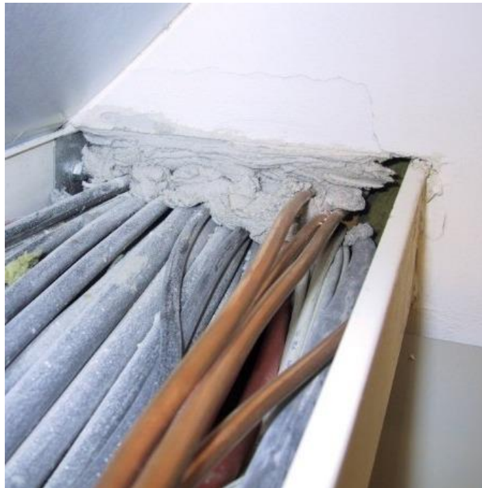
Obr. 56 Prostup není protipožárním materiálem zcela vyplněn
