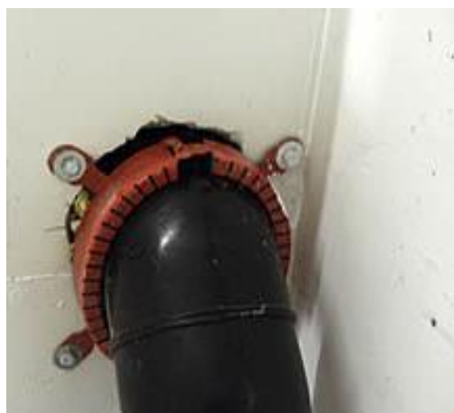
Obr. 54 Příliš velký otvor v požárně dělící konstrukci, požár se bude šířit kolem manžety
