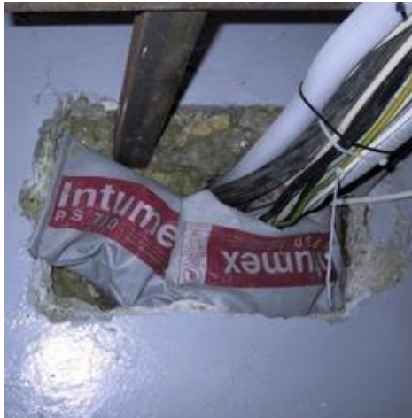
Obr. 55 Nedostatečné utěsnění prostupu protipožárními polštáři
