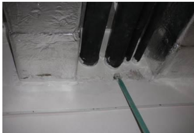
Obr. 51 Protipožární nátěr bez přesahů na okolní konstrukci a instalace
