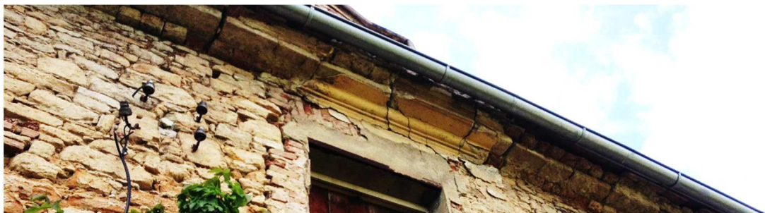
3.38 Trhliny v nadokenním prostoru na jihovýchodní fasádě
