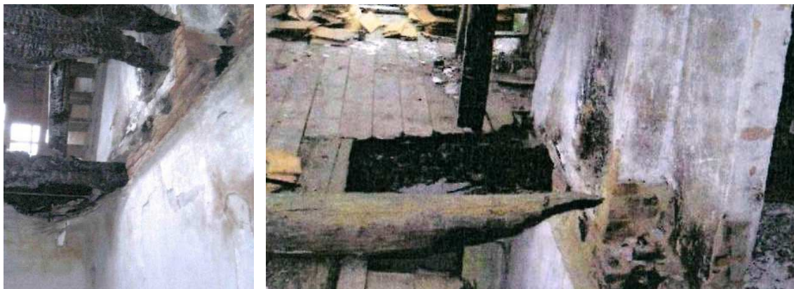
3.41, 3.42 Prohořelý, propadlý strop v severní části objektu
