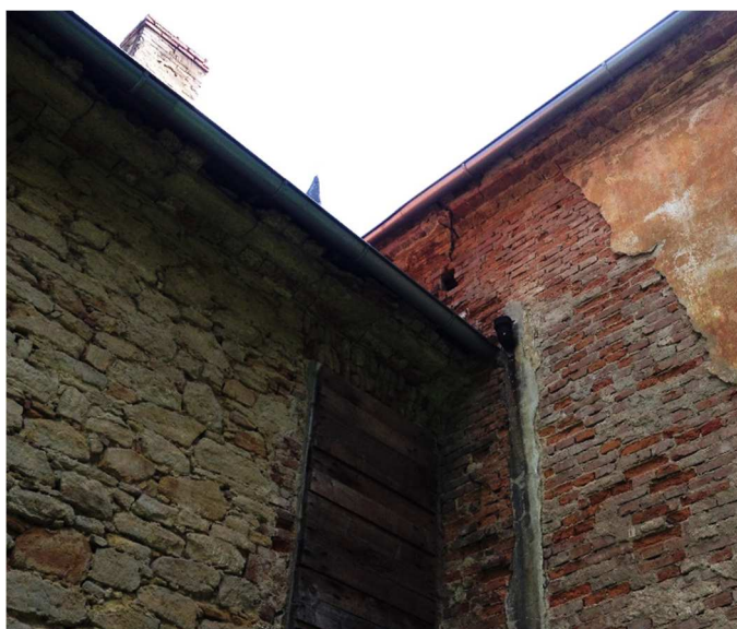
3.32 Trhlina mezi přístavbou a původní stavbou
