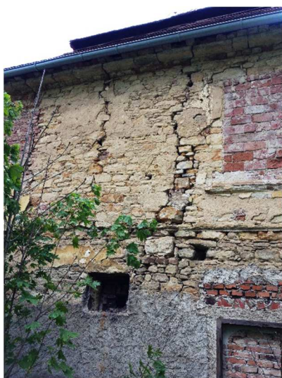
3.24 Souběžné trhliny na severovýchodním průčelí
