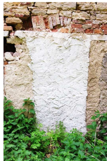
Obr. 2.18 Zazděný vchod do kotelny
