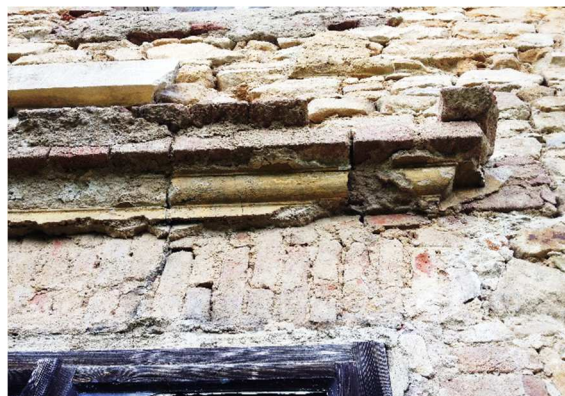
3.46 Detail porušené nadokenní římsy
