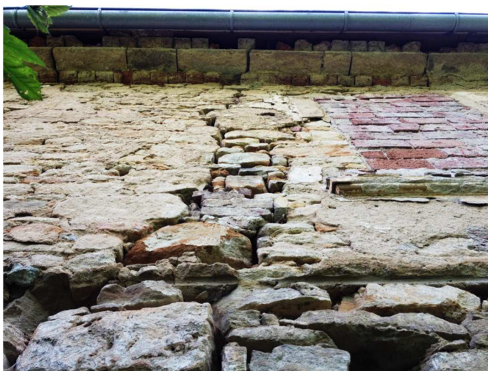
3.25 Detail pravé trhliny prostupující konstrukci severovýchodního průčelí
