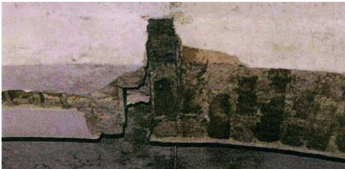
3.39 Chybějící klenák v klenebném pasu u vstupní haly v severozápadní části objektu
