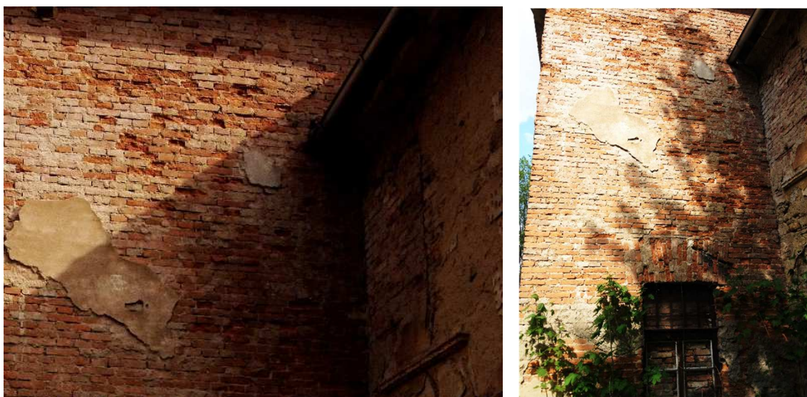
Obr. 2.5, 2.6 Cihelné zdivo na pozdější přístavbě k objektu.
