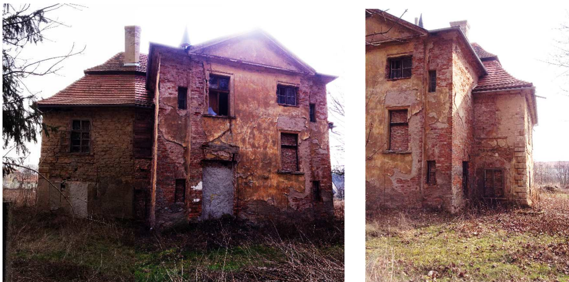
3.16, 3.17 Vlhkostní mapy na severozápadní fasádě
