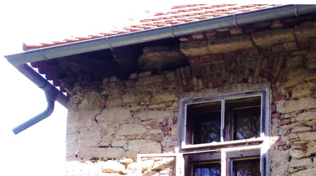
3.43, 3.44 Obnažené krokve v úrovni porušené okapní římsy
