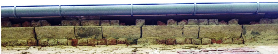
3.18, 3.19, 3.20 Porušená okapní římsa s novým okapem
