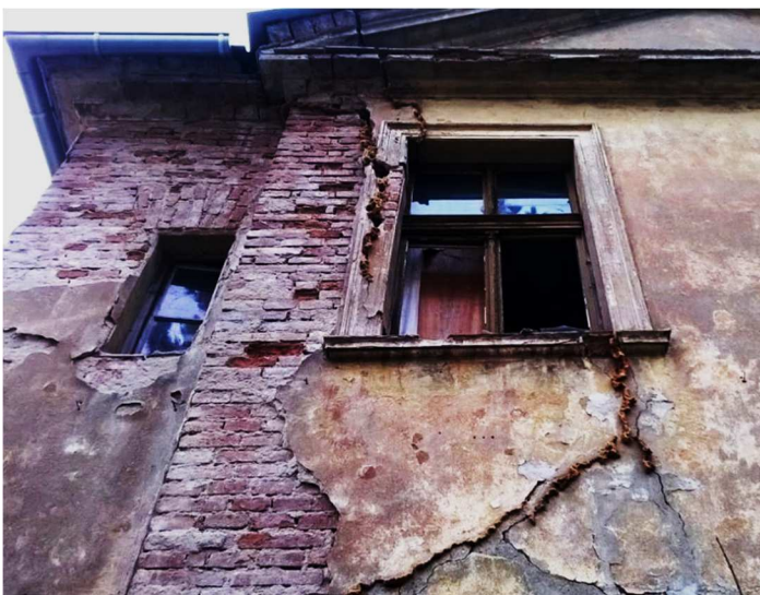
3.29, 3.30 Trhlina na přístavbě severozápadního průčelí vyplněná pěnou
