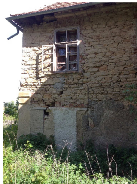
3.21, 3.22 Chybějící okapní římsa v rozích
