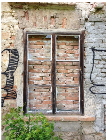
3.47 Okno s pozůstatky skla
