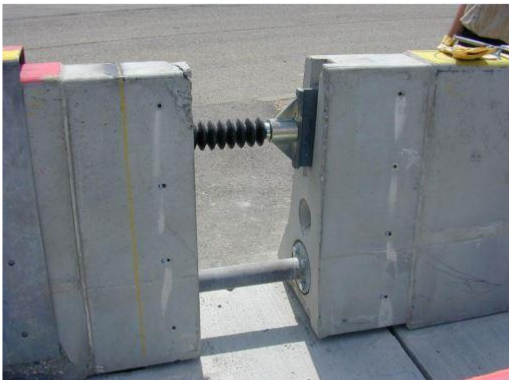
obrázek číslo 12. - spojení betonového svodidla
