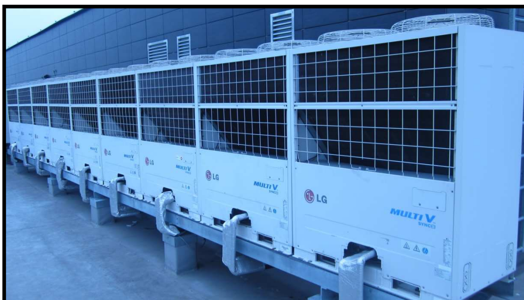
Obrázek 6-2 – Aktuálně instalované vnější jednotky klimatizace LG
