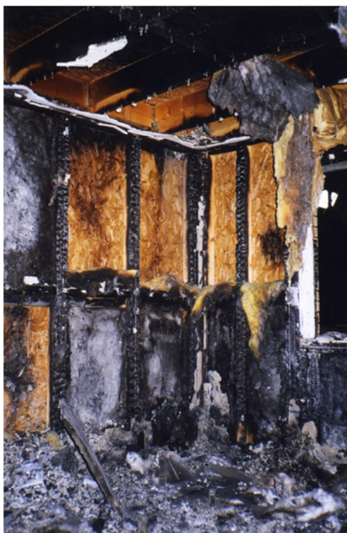
Obr. 11 Požární úsek po zasažení požárem
