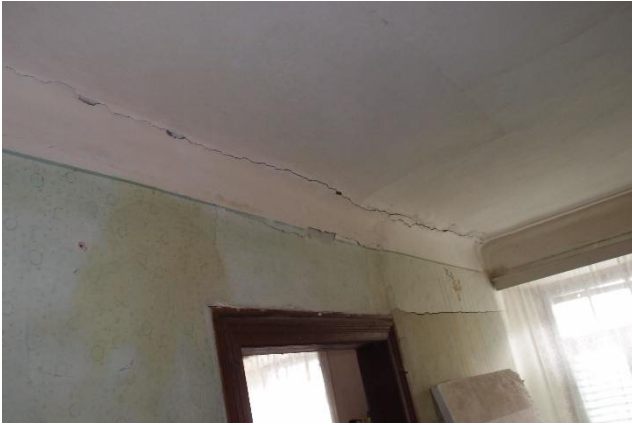
foto 36 – Trhlina omítky při styku dělicí přičky mezi místnostmi 1.07 a 1.08 a stropu, foceno z místnosti 1.07 pozn.: Ve stavebně technické dokumentaci s označením TR 4
