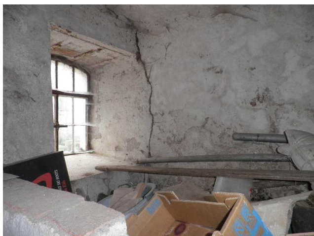
foto 69- Trhlina ve východním rohu místnosti chlívku pozn.: Ve stavebně technické dokumentaci s označením TR 8
