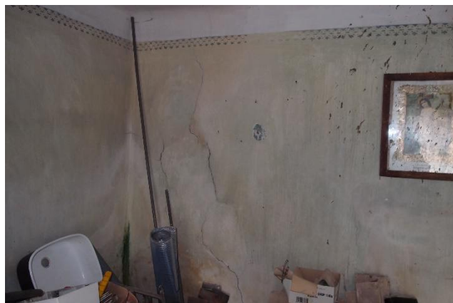
foto 35 – Trhliny v dělicí příčce mezi místností 1.07 a 1.08 pozn.: Ve stavebně technické dokumentaci s označením TR 3
