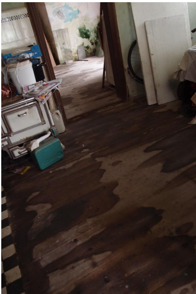
foto 28 – Stopy vlhkosti na nášlapné vrstvě podlahy
