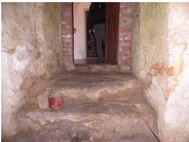
foto 26 – Vlhkost stěn při výstupu ze sklepa (místnost 1.06)
