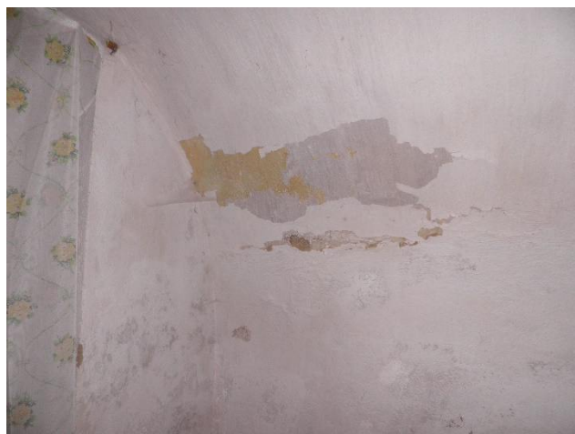
foto 24 – Vlhkost vnitřní stěny
