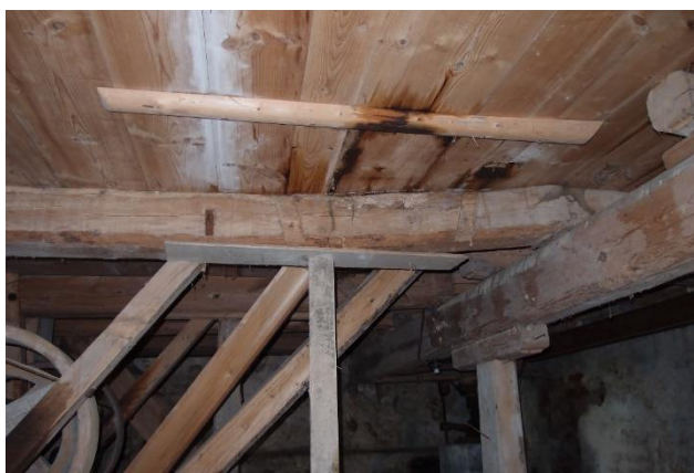
foto 62 - Nadměrný průhyb stropního trámu a jeho provizorní podepření sloupkem
