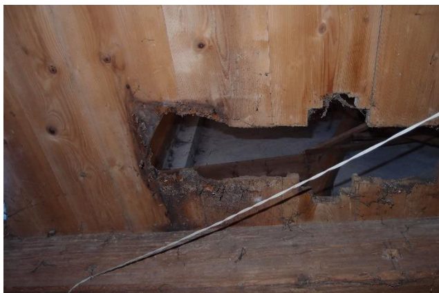
foto 98 - Díra v nášlapné vrstvě stropu vzniklá průchodem vertikálního prvku
