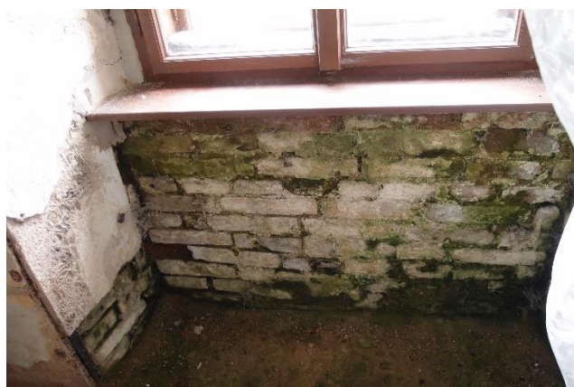
foto 33 – Parapet a ostění okenního otvoru v juhozápadní stěně
