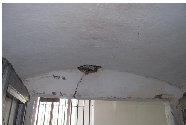
foto 19 – Trhlina v místě nadpraží dveřního otvoru pozn.: Ve stavebně technické dokumentaci s označením TR 1
