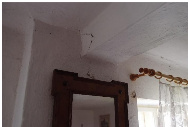
foto 73 – Trhlina v místě uložení průvlaku (severovýchodní stěna) a trhlina v podhledu stropu pozn.: Ve stavebně technické dokumentaci s označením TR 10 a TR 11
