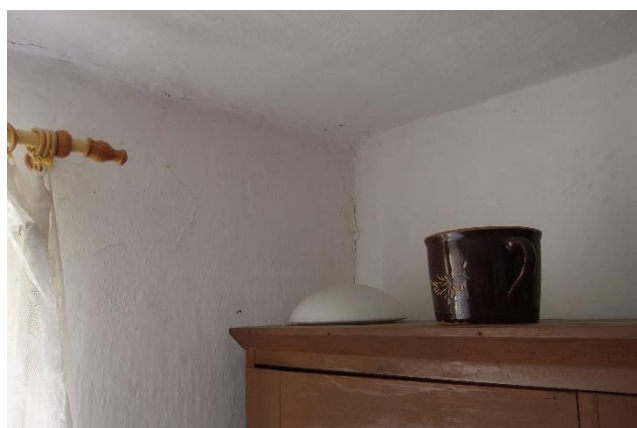
foto 75 – Svislá trhlina ve východním rohu místnosti a trhlina fabionu pozn.: Ve stavebně technické dokumentaci s označením TR 20 a TR 14
