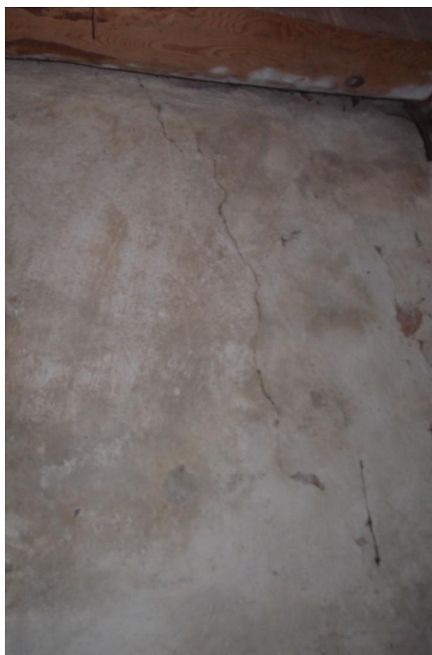
foto 50 - Trhliny vnitřní nosné stěny mezi prostorem muzea (místnost 1.09) a prostorem mlýnice (místnost 1.10), foceno z místnosti 1.10 pozn.: Ve stavebně technické dokumentaci s označením TR 5
