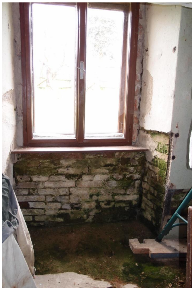
foto 31 – Otvor v juhozápadní obvodové stěně, stopy vlhkosti a biologické degradace
