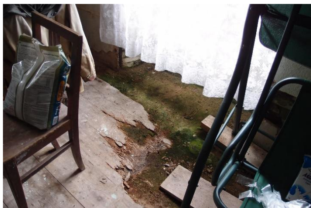
foto 30 – Degradovaná část nášlapné vrstvy podlahy hnilobnými procesy
