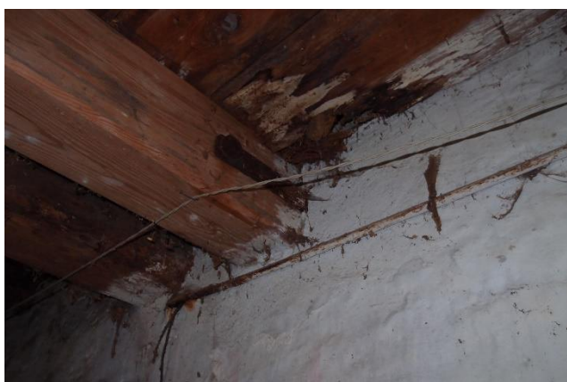
foto 88- Nášlapná vrstva stropní konstrukce krovu degradována hnilobným procesem
