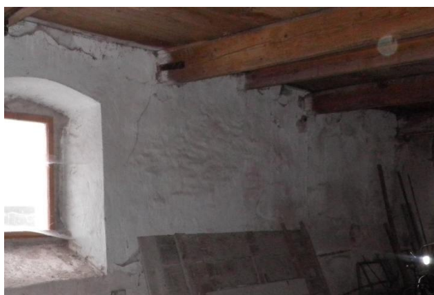
foto 89- Trhlina v severovýchodní obvodové stěně v místě uložení stropního trámu pozn.: Ve stavebně technické dokumentaci s označením TR 26
