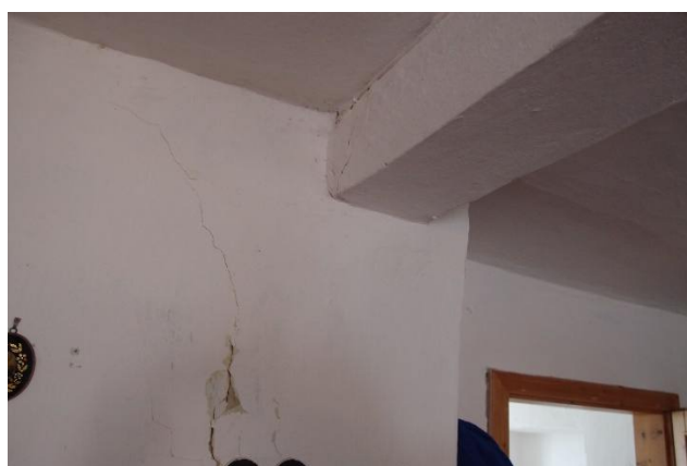
foto 76 – Trhlina průvlaku a trhlina v jihozápadní stěně místnosti 2.02 pozn.: Ve stavebně technické dokumentaci s označením TR 15 a TR 16
