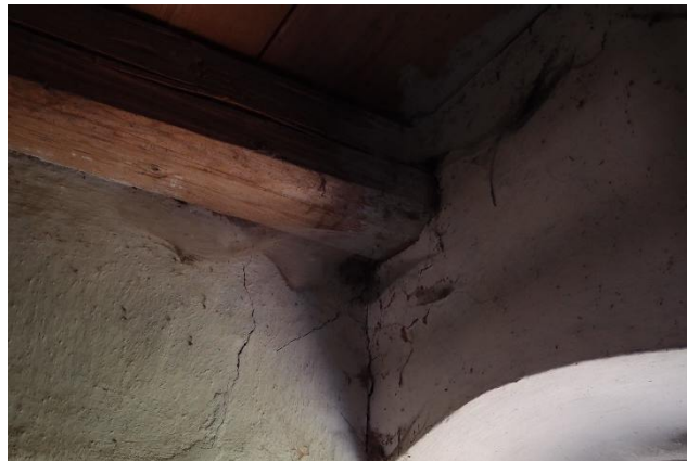
foto 99 - Trhlina v jižním rohu mlýnice pozn.: Ve stavebně technické dokumentaci s označením TR 30
