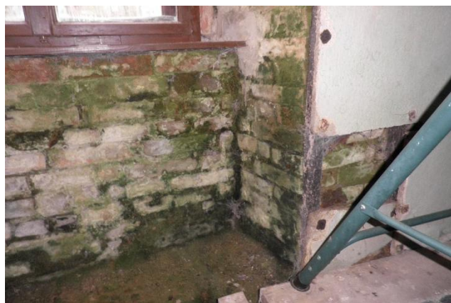
foto 32 – Parapet a ostění okenního otvoru v juhozápadní stěně
