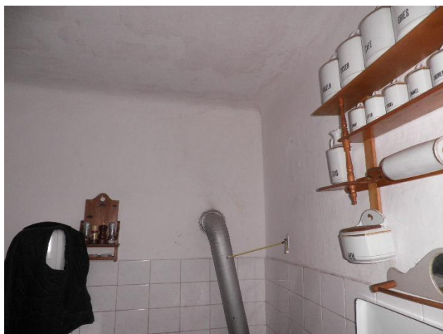
foto 77 – Stopy vlhkosti na podhledu stropní konstrukce
