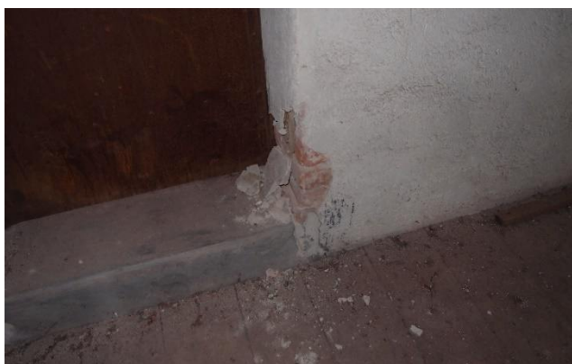
foto 106 – Poškozená povrchová vrstva v ostění otvoru (foceno z místnosti 3.02)
