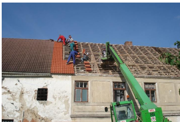
foto 6 – Pohled od jihozápadu na krov nad obytnou částí při rekonstrukci střešního pláště (rok 2007)
