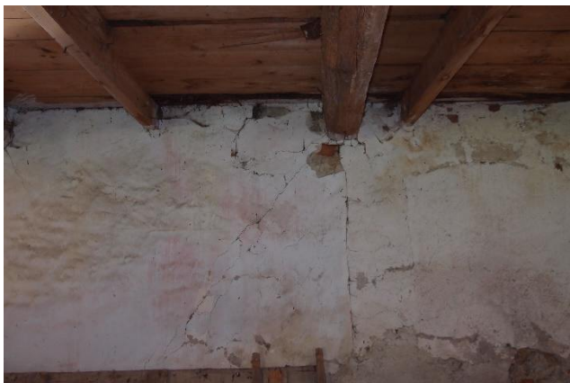
foto 90- Trhlina v severovýchodní obvodové stěně v místě uložení stropního trámu pozn.: Ve stavebně technické dokumentaci s označením TR 27
