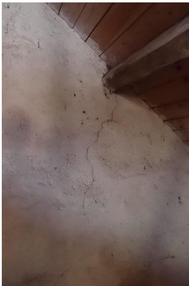
foto 105 – Trhlina v místě uložení vaznice krovu (foceno z místnosti 3.01) pozn.: Ve stavebně technické dokumentaci s označením TR 33
