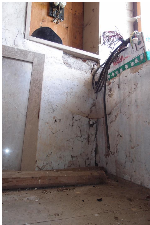
foto 97 - Trhlina v jižním rohu mlýnice pozn.: Ve stavebně technické dokumentaci s označením TR 30
