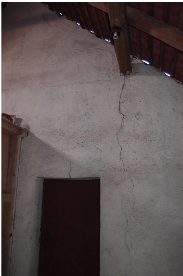
foto 104 – Trhliny ve vnitřní stěně krovu (foceno z místnosti 3.01) pozn.: Ve stavebně technické dokumentaci s označením TR 34 a TR 35
