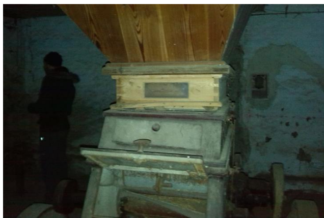
foto 102 - Zdeformovaná výsypka (silo) pozn.: Příčinou nadměrného průhybu stropního průvlaku v rámci 1.NP je právě tato výsypka
