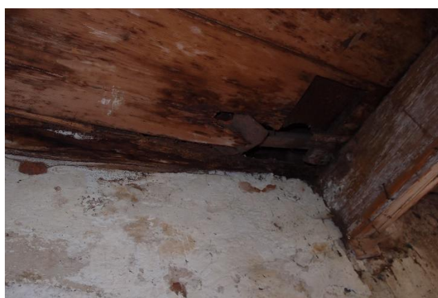
foto 92- Nášlapná vrstva stropní konstrukce krovu degradována hnilobným procesem
