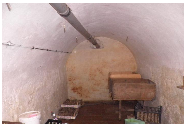
foto 20 – Stopy vlhkosti uvnitř spižírny (místnost 1.03)
