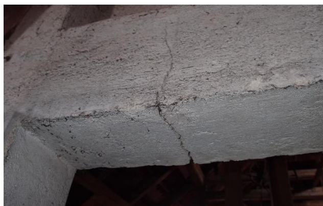
foto 107 – Trhlina v nadpraží otvoru (foceno z místnosti 3.02) pozn.: Ve stavebně technické dokumentaci s označením TR 35
