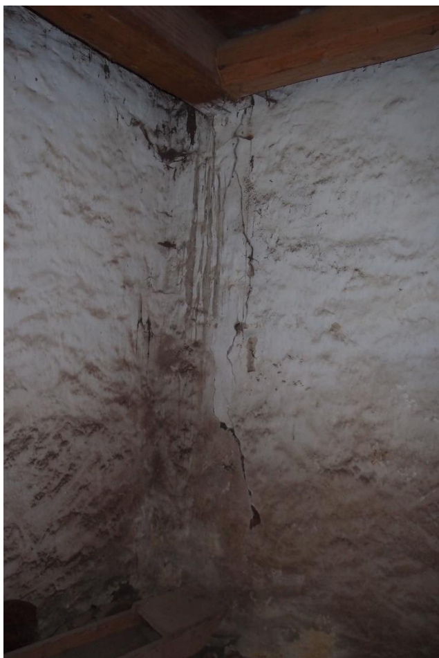
foto 85- Trhlina u severního rohu mlýnice pozn.: Ve stavebně technické dokumentaci s označením TR 25
