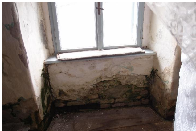
foto 34 – Otvor v jihovýchodní stěně, známky biologické degradace a vlhkosti
