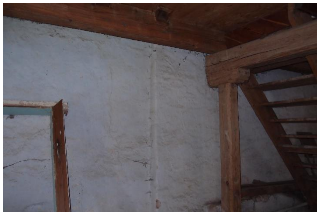
foto 101 - Trhlina severozápadní obvodové stěny pozn.: Ve stavebně technické dokumentaci s označením TR 32
