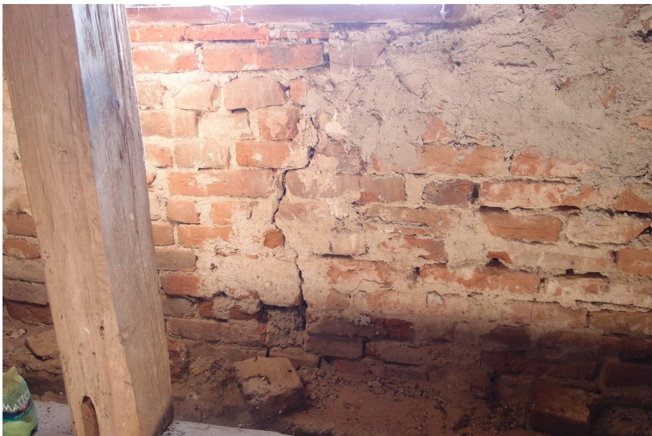
foto 108 – Trhlina pod oknem ve štítové stěně objektu (jihovýchodní strana) pozn.: Ve stavebně technické dokumentaci s označením TR 36
