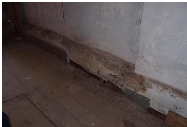
foto 95- Degradace povrchové vrstvy při styku obvodových stěn 1.NP a 2.NP (jihozápadní stěna)
