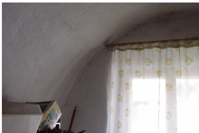
foto 78 – Trhlina na styku valené klenby a severovýchodní obvodové stěny pozn.: Ve stavebně technické dokumentaci s označením TR 18
