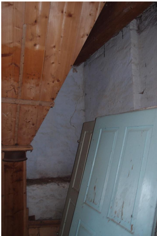
foto 100 - Trhlina u západního rohu mlýnice pozn.: Ve stavebně technické dokumentaci s označením TR 31
