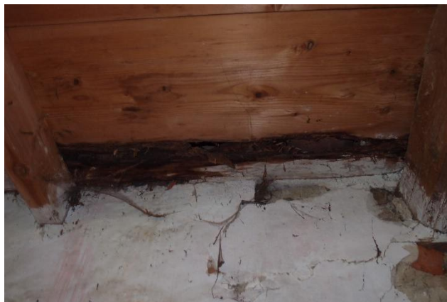
foto 91- Nášlapná vrstva stropní konstrukce krovu degradována hnilobným procesem
