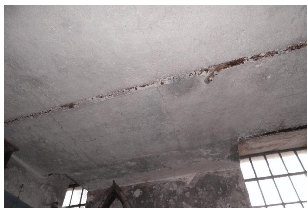
foto 66 - Trhlina stropní konstrukce v prostoru muzea (místnost 1.11) pozn.: Ve stavebně technické dokumentaci s označením TR 7
