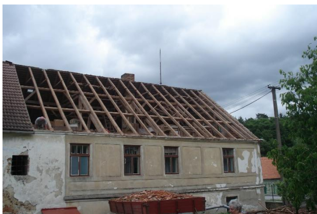
foto 5 – Pohled od jihozápadu na krov nad obytnou částí při rekonstrukci střešního pláště (rok 2007)
