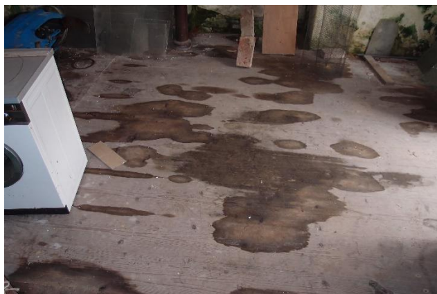
foto 29 - Stopy vlhkosti na nášlapné vrstvě podlahy
