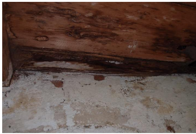
foto 93- Nášlapná vrstva stropní konstrukce krovu degradována hnilobným procesem
