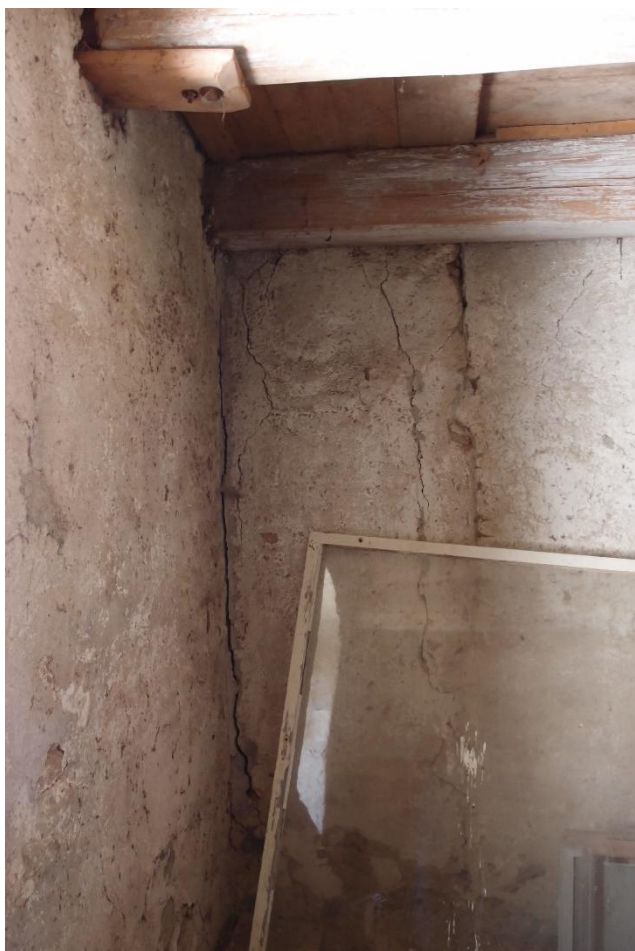
foto 96 - Trhlina pilíře podpírajícího stropní trám pozn.: Ve stavebně technické dokumentaci s označením TR 29
