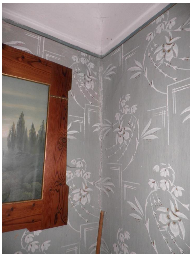
foto 81 – Trhlina na styku příčky a vnitřní nosné stěny (foceno z místnosti 2.06)
