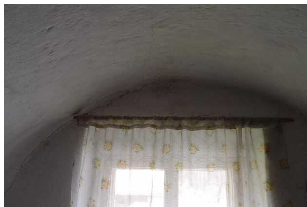
foto 79 – Trhlina u vrcholu valené klenby pozn.: Ve stavebně technické dokumentaci s označením TR 19
