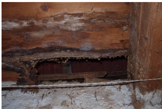
foto 87- Nášlapná vrstva stropní konstrukce krovu degradována hnilobným procesem
