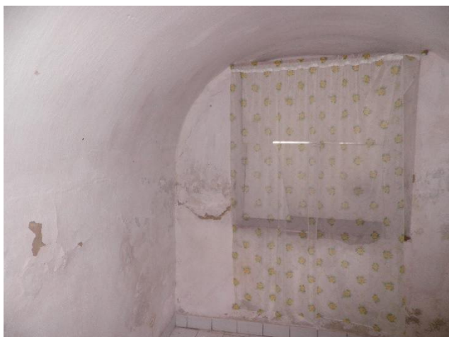
foto 23 – Severovýchodní obvodová stěna a stopy vlhkosti kolem okenního otvoru
