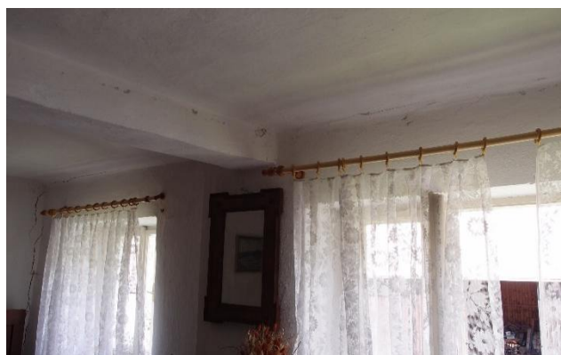
foto 74 – Trhlina průvlaku a trhlina fabionu pozn.: Ve stavebně technické dokumentaci s označením TR 12 a TR 13
