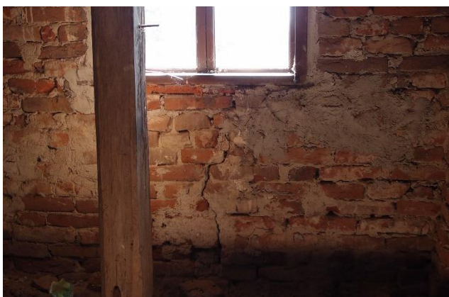
obr. 29 – Tahová trhlina pod okenním otvorem v JV štítové stěně podkroví
