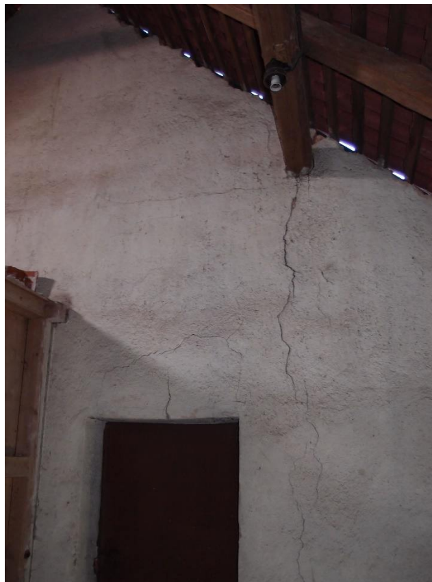
obr. 28 – Tahové trhliny v oslabených místech vnitřní stěny pozn.: Ve stavebně technickém průřezu s označením TR 34 a TR 35
