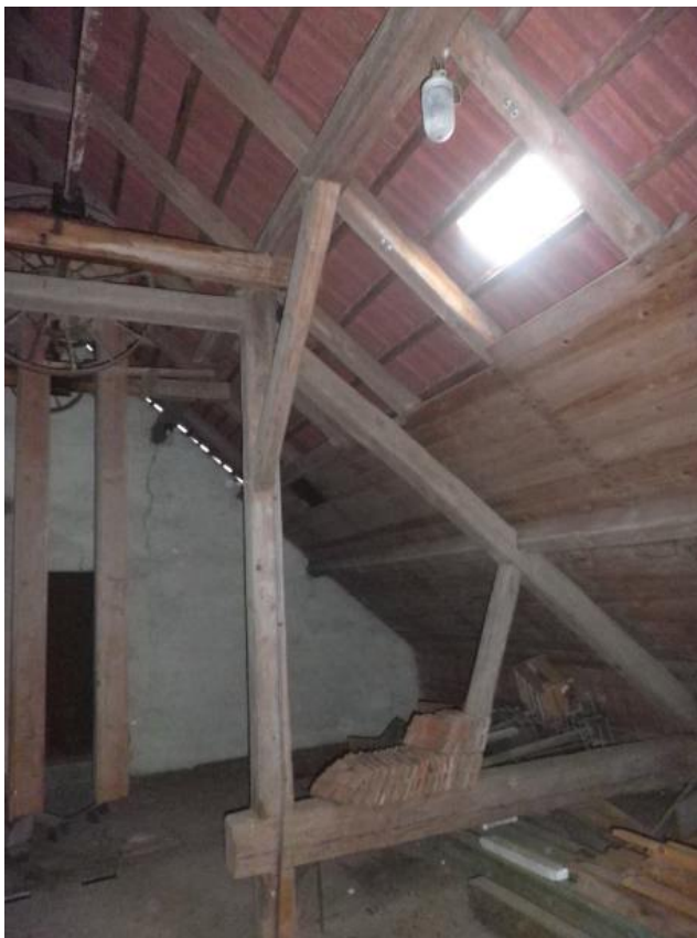
obr. 27 – Přerušení vazného trámu v plné vazbě krovu
