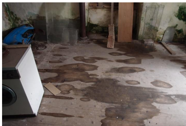
obr. 23 – Prosakující vlhkost v nášlapné vrstvě podlahy v místnosti 1.08
