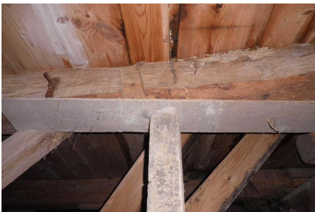
obr. 33 – Nadměrný průhyb průvlaku v místnosti 1.10
