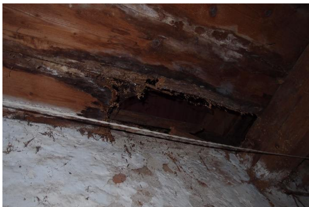
obr. 31 – Hniloba nášlapné vrstvy stropu podkrovní
