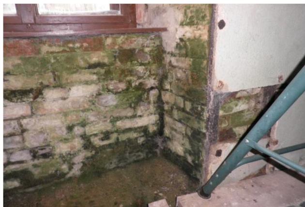
obr. 15 – Parapet a ostění okenního otvoru v jihozápadní stěně místnosti 1.07 (viz též foto 32)
