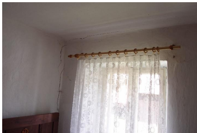
obr. 34 – vodorovná trhлина fabionu navazující na svislou trhlinu na styku stěn
