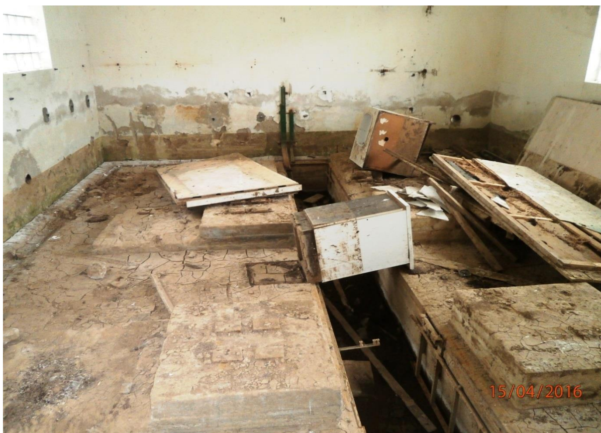
Obrázek 24 – Interiér odběrného objektu
