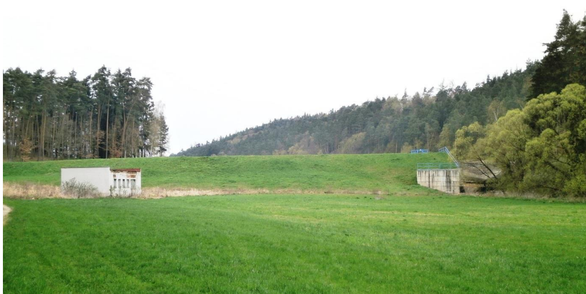
Obrázek 5 – Pohled na vzdušný líc hráze, vlevo odběrný objekt a vpravo bezpečnostní přeliv.
