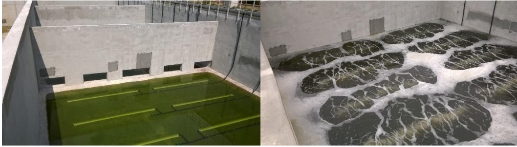
Obr. 49 - Novonainštalované pneumatické aerátory v nitrifikačných nádržiach [3]
