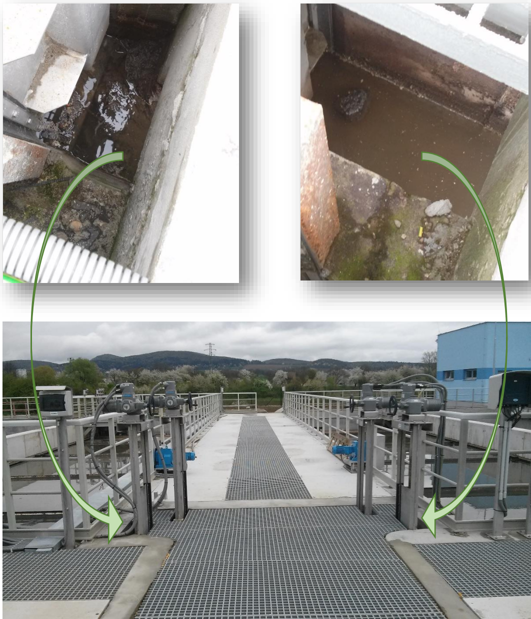
Obr. 64 - Rozdeľovací objekt pred usadzovacími nádržami [4]
