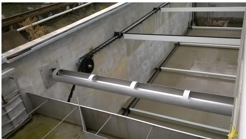
Obr. 45 - Novovybudovaná usadzovacia nádrž s náklonným žlabom [3]
