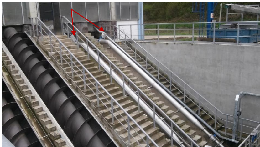
Obr. 63 - Ventily ponorných výtlačných potrubí [4]
