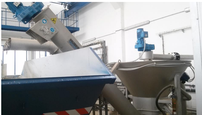
Obr. 43 - Novonainštalovaný separátor piesku [4]
