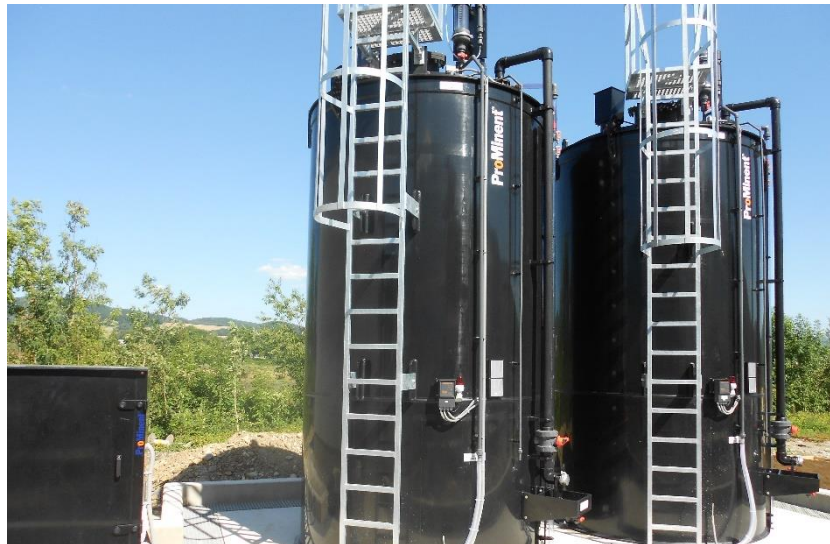
Obr. 50 - Nádrže na koagulačné činidlo síran železitý [3]
