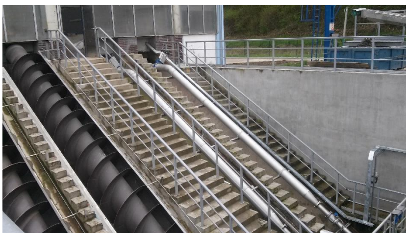
Obr. 37 - Zrekonštruovaná čerpacia stanica s novými výtlačnými a závitovými čerpadlami [4]
