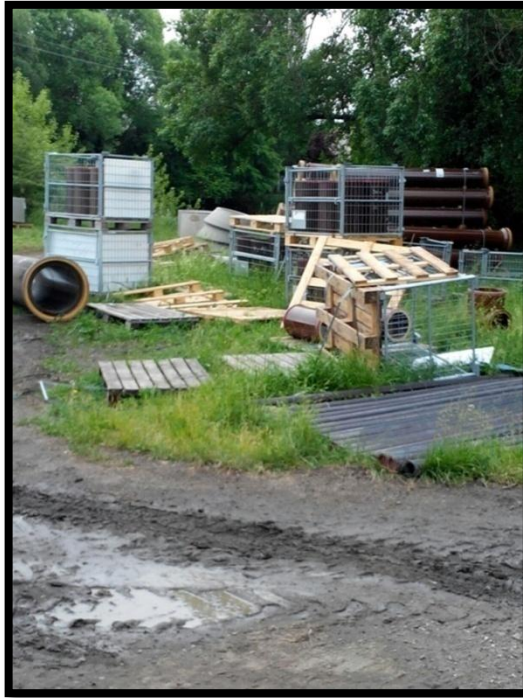
Fotografie 1: Nedostatečně zabezpečené staveniště a nevhodně uložený materiál (foto: Marie Srchová, 2016)
