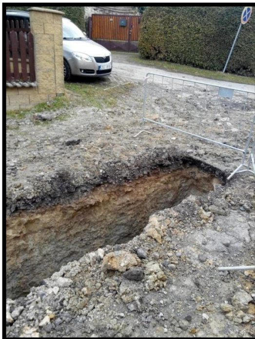
Fotografie 2: Chybějící zábory kolem výkopu (foto: Marie Srchová, 2016)
