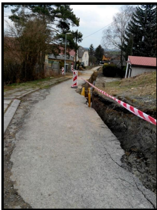
Fotografie 3: Nedostatečně zapažení výkopu (foto: Marie Srchová, 2016)
