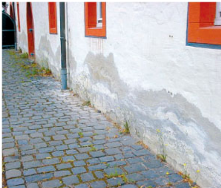
Obrázek 4: Poškození fasády vlivem vzlínající vody [34]
