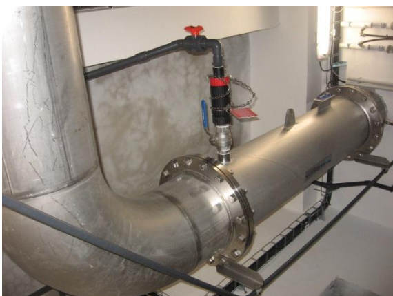
Obrázek 33: Odtok upravené vody po chloraci do akumulační nádrže
