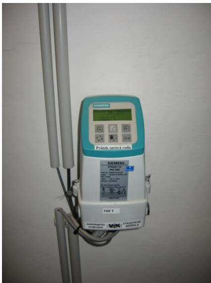
Obrázek 37: Průtokoměr surové vody před dávkováním koagulantu
