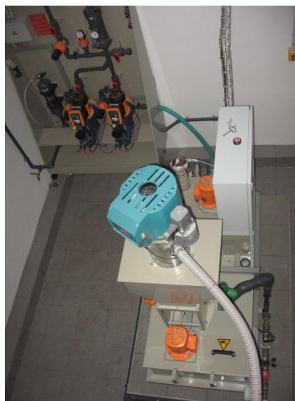
Obrázek 16: Statický mísič, jednotka pro přípravu koagulantu a dávkovací čerpadla
