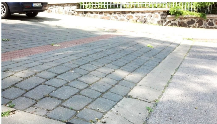
Obr. 27: Zpomalovací práh – vjezd ke škole (zdroj: archiv autora)
