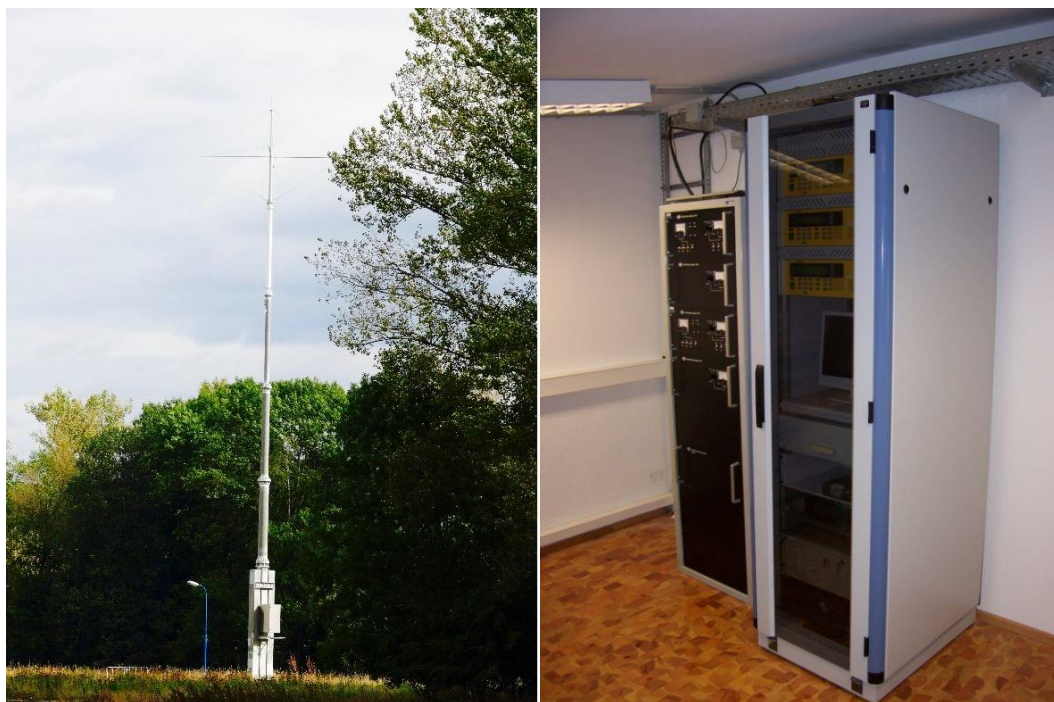
Obrázek č. 2 Vysílací anténa a systémová místnost. Zdroj [45]
