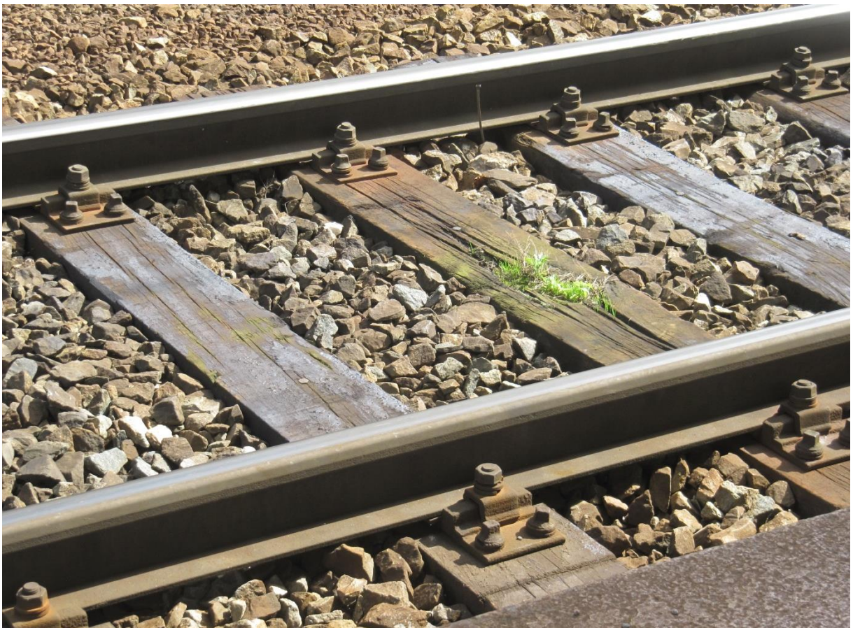
Obrázek A.6: Detail kolejnice s tuhým upevněním a prorostlými pražci ve staniční koleji
