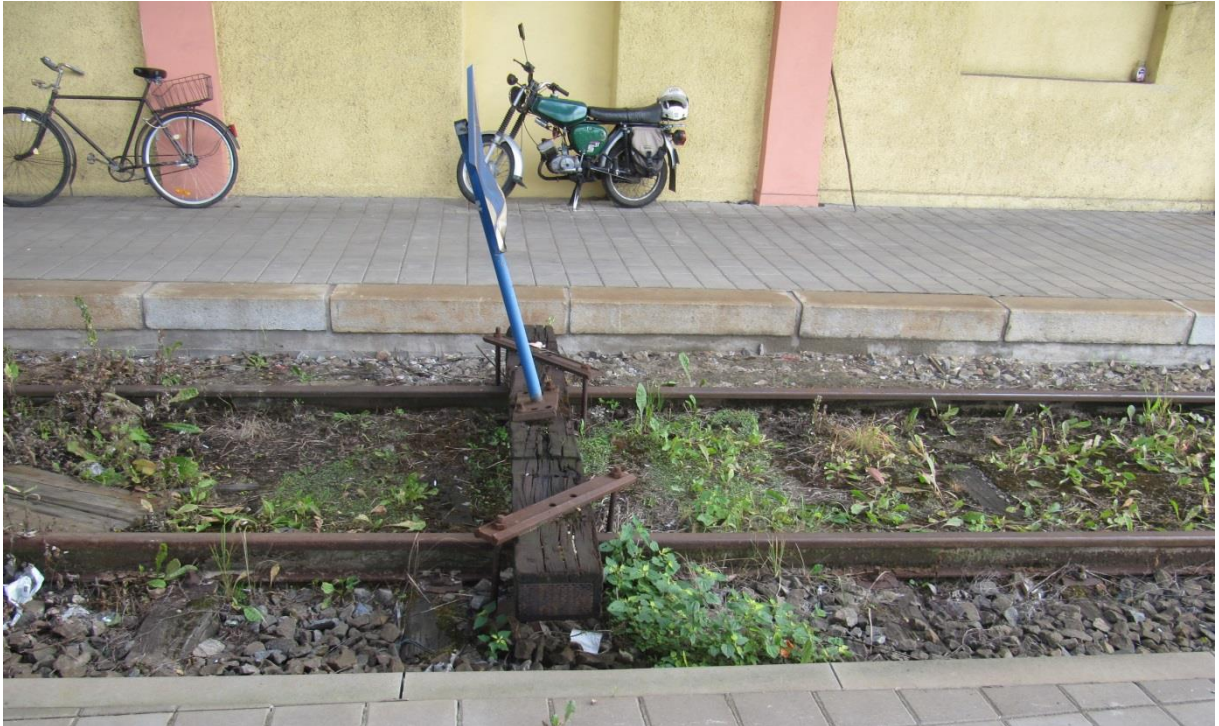
Obrázek A.5: Kusé zakončení poštovní koleje č. 18
