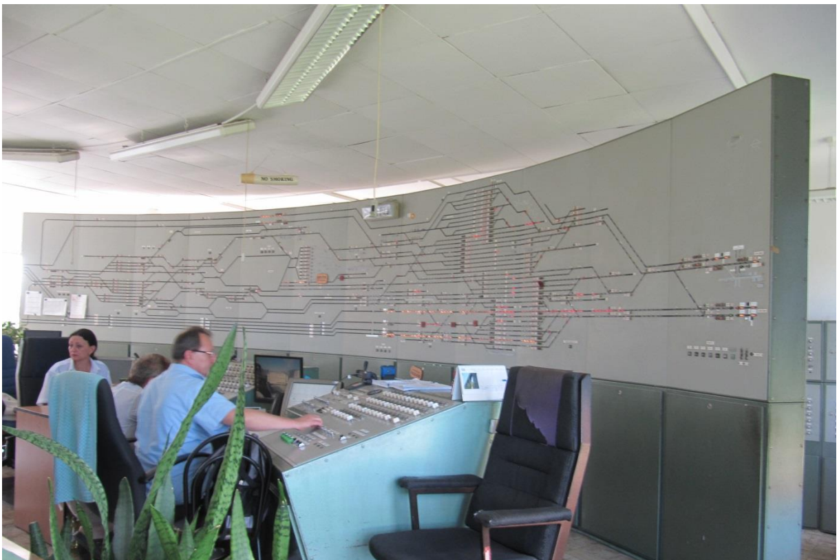
Obrázek A.8: Reléové zabezpečovací zařízení v budově stavědla 019
