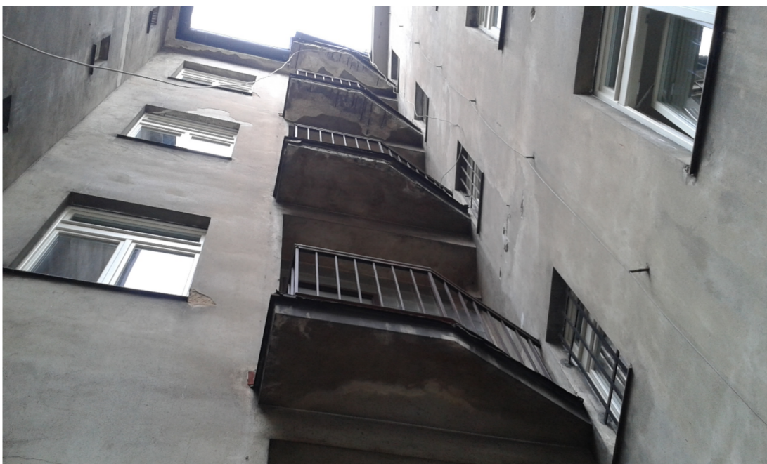
Obrázek 6 – Stávající stav konstrukcí balkónů
