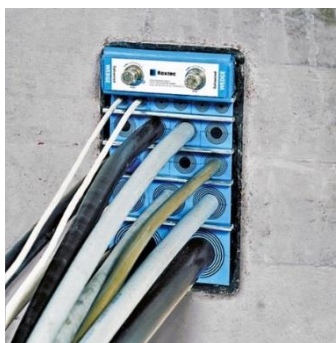
Obr. 10 – Kabely těsněné speciální požární ucpávkou [15]
