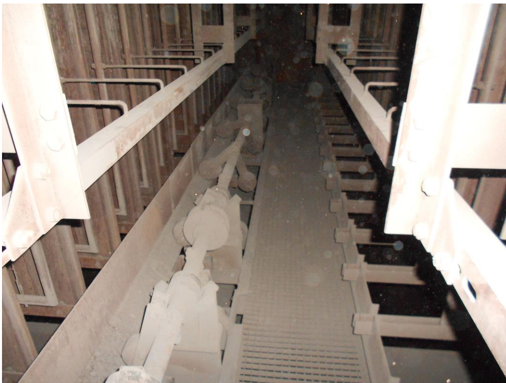
Obr. 3.4 Detail mezery mezi sekcemi – zde je vidět rošt pro snadný pohyb pracovníků údržby, oklepávací kladívka oklepu usazovacích elektrod a uchycení rámu vysokonapěťových elektrod (vlastní fotografie s vědomím provozovatele)
