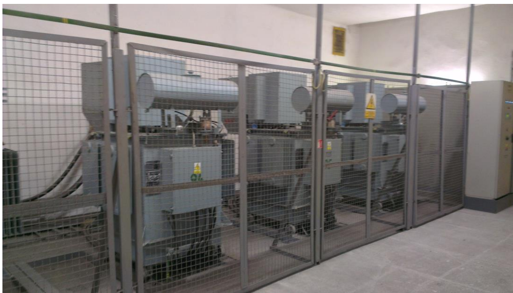
Obr. 3.11 VN transformátory (zde olejové) se skříněmi řízení (vpravo) (vlastní fotografie s vědomím provozovatele)
