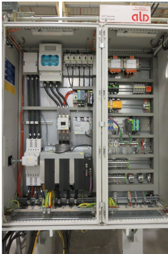
Obr. 6: rozvodná skříň pece BK s řídicími prvky
