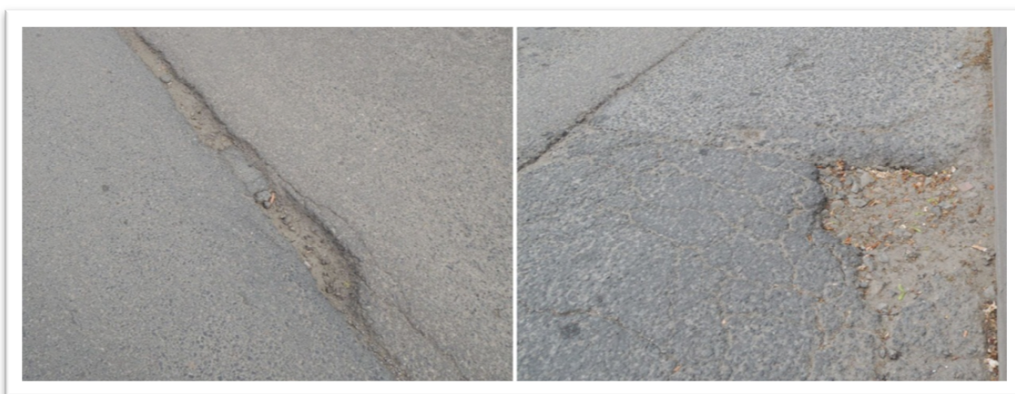
Obrázek 3.7: Vysprávkky (zdroj: foto autor)
