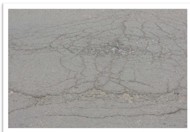
Obrázek 3.8: Mozaiková trhlinka (zdroj: foto autor)
