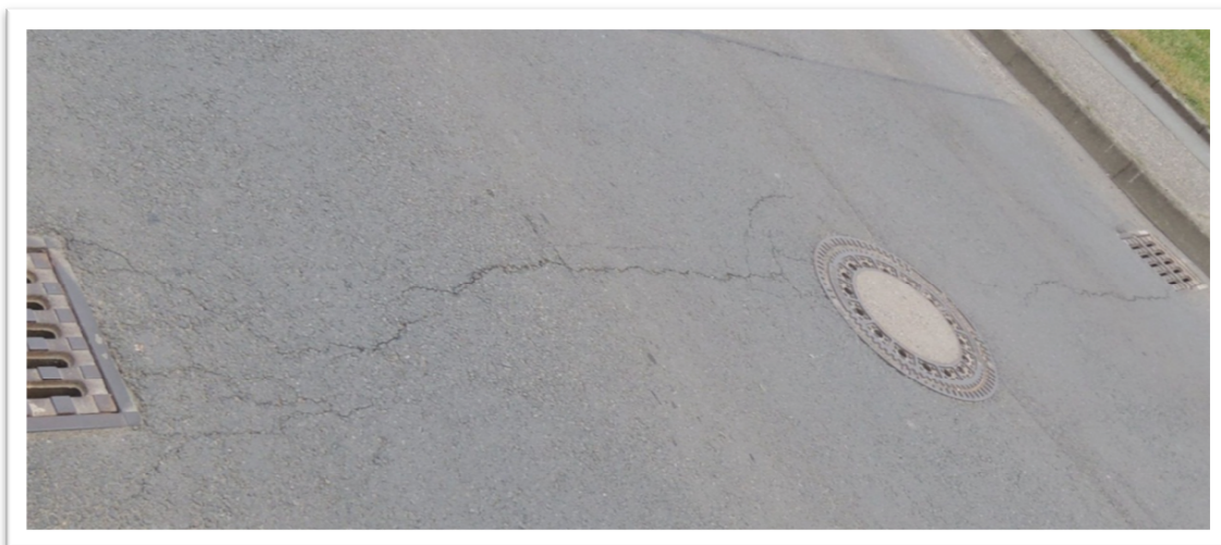
Obrázek 3.9: Trhlina úzká příčná (zdroj: foto autor)
