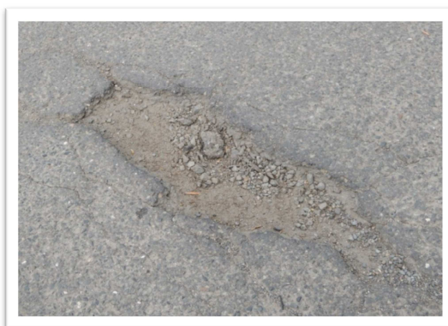
Obrázek 3.6: Výtluk (zdroj: foto autor)
