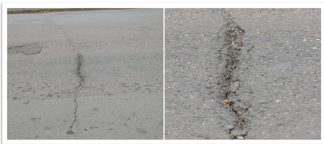
Obrázek 3.10: Trhlina široká příčná (zdroj: foto autor)
