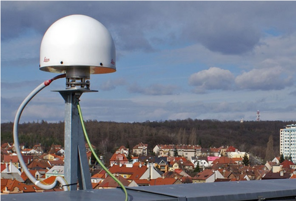
Obrázek 8.2: Ukázka permanentní stanice [8]
