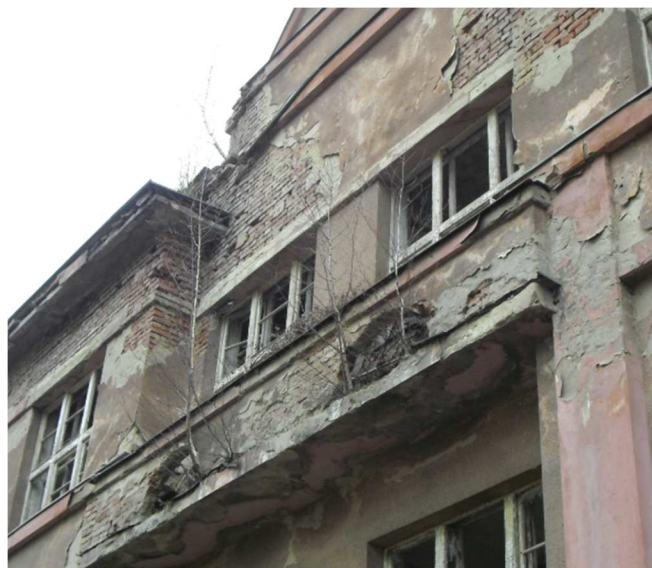
Obrázek 9: Narušená omítka fasády jižního objektu.
