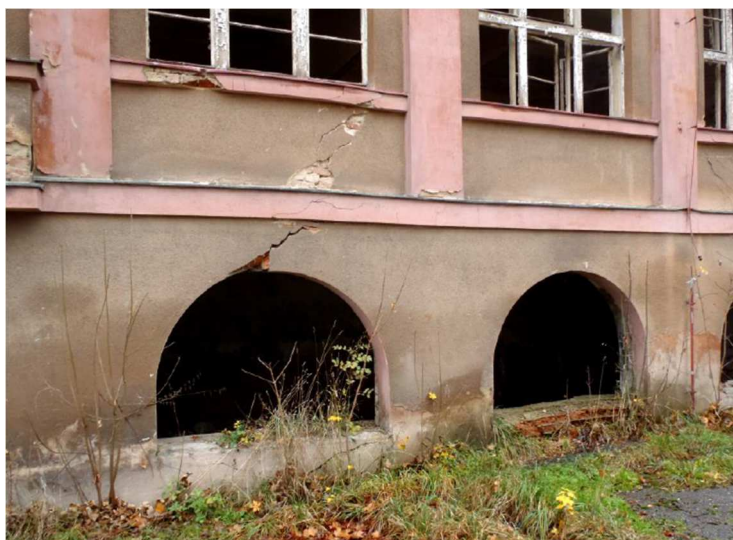
Obrázek 8: Pokles části zdi jižního průčelí kotelny. [2]
