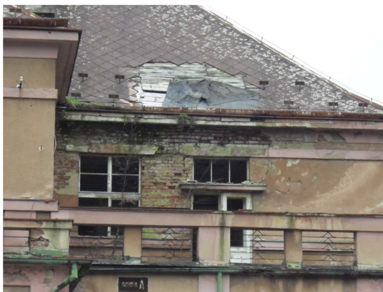
Obrázek 11: Ukázka stavu hydroizolace a dešťových svodů.
