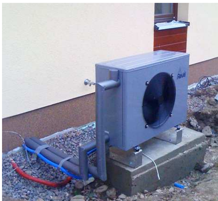
Obr. 45 Venkovní jednotka tepelného čerpadla
