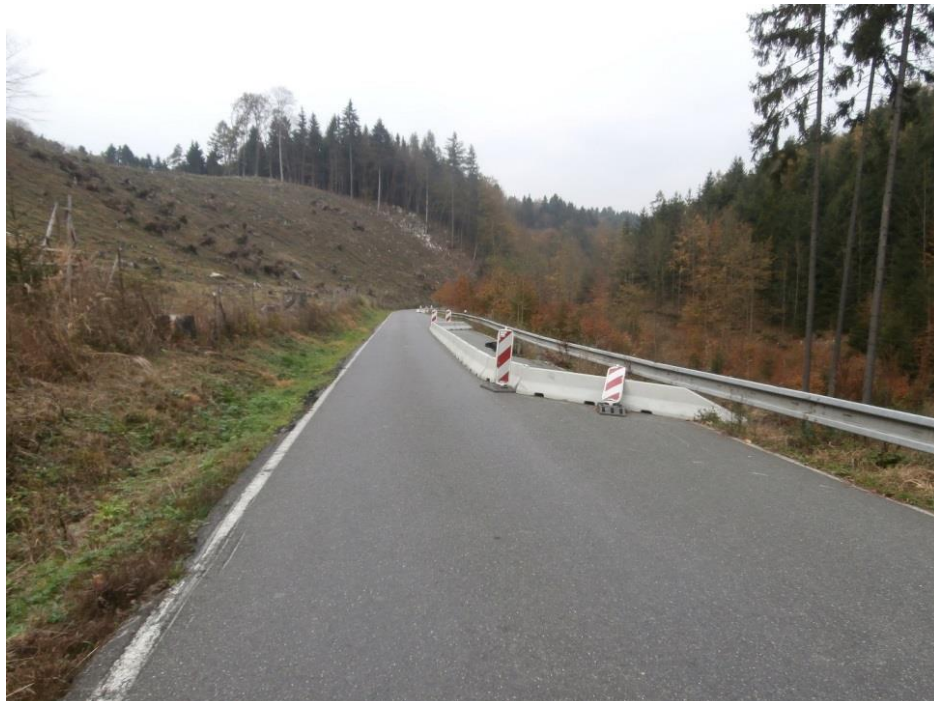
Obr. 26 - Propadlá vozovka, zdroj: Tomáš Seliger
