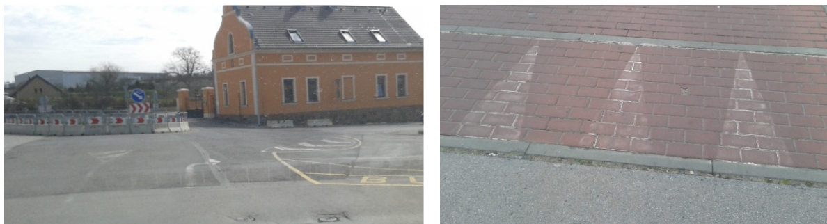
Obr.6 a 7: Opotřebeně vodorovné značení
