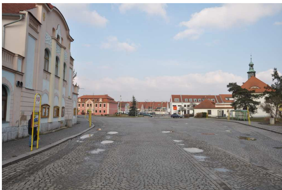
Obrázek 21: Pohled na současné autobusové nádraží, zvlněný povrch vozovky
