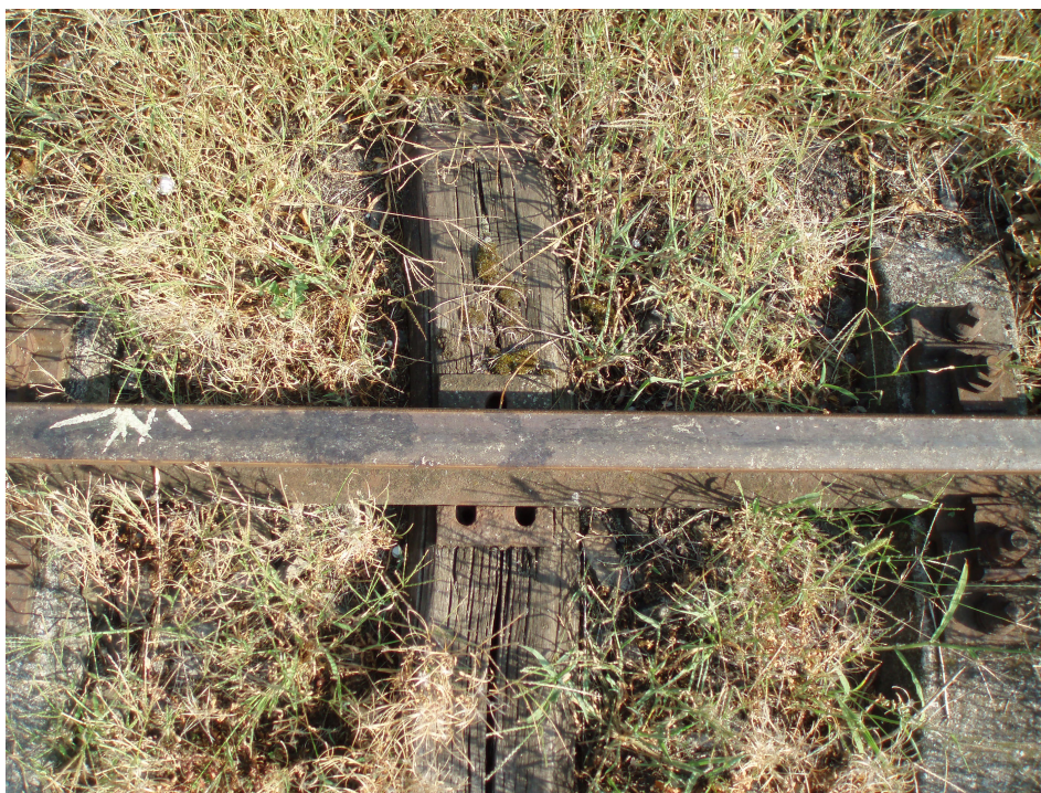
Obrázek 4 Železniční svršek u zastávky Semeč. Shnilý dřevěný pražec s chybějícím upevněním uprostřed betonových pražců
