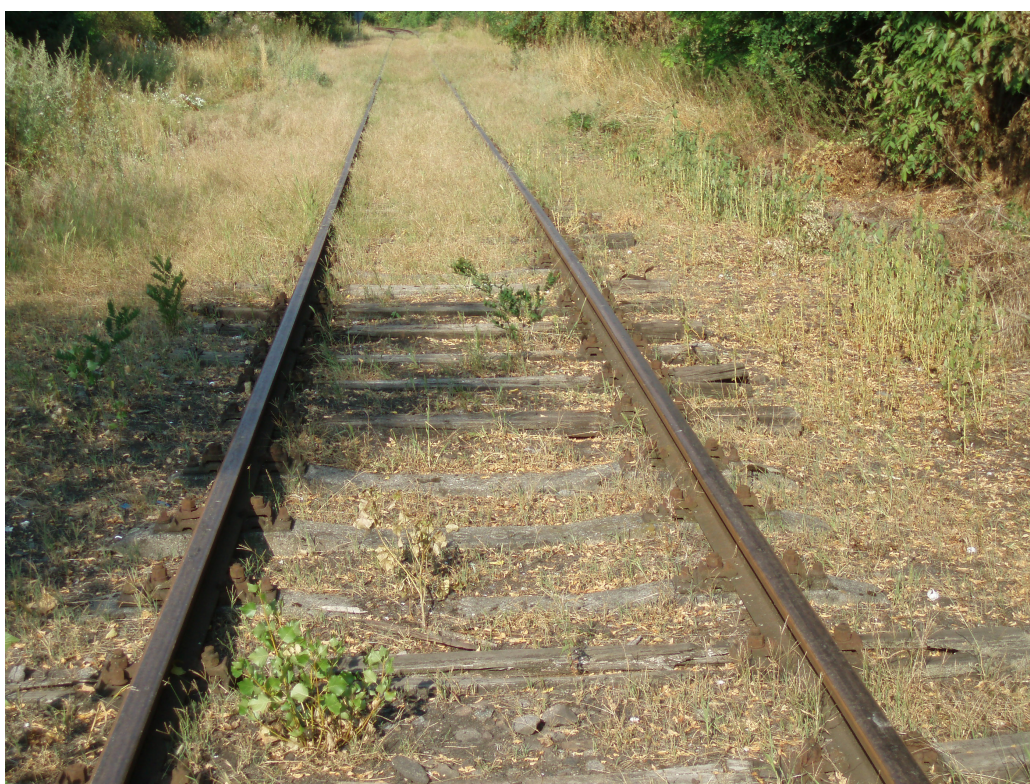
Obrázek 5 Shnilé a propadlé dřevěné pražce, v pozadí betonové pražce VUS 62
