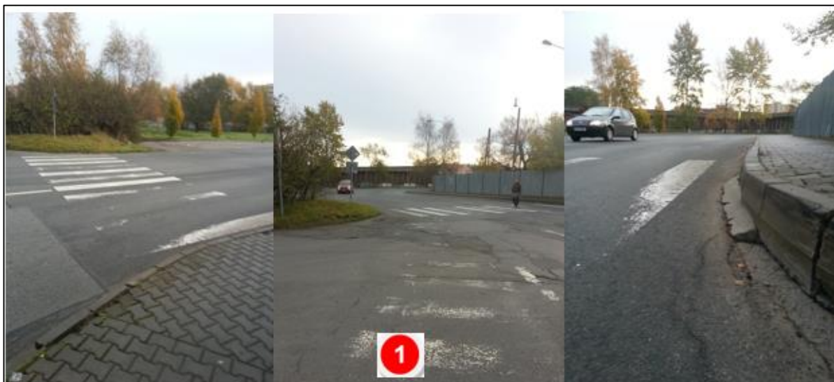
Obrázek 7 - Fotodokumentace nedostatku č. 1
