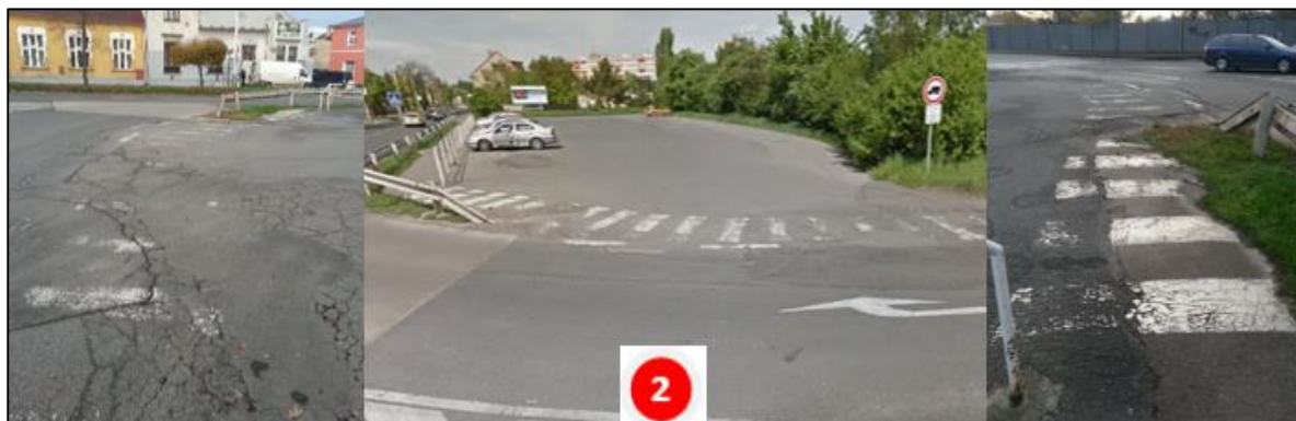
Obrázek 8 - Fotodokumentace nedostatku č. 2
