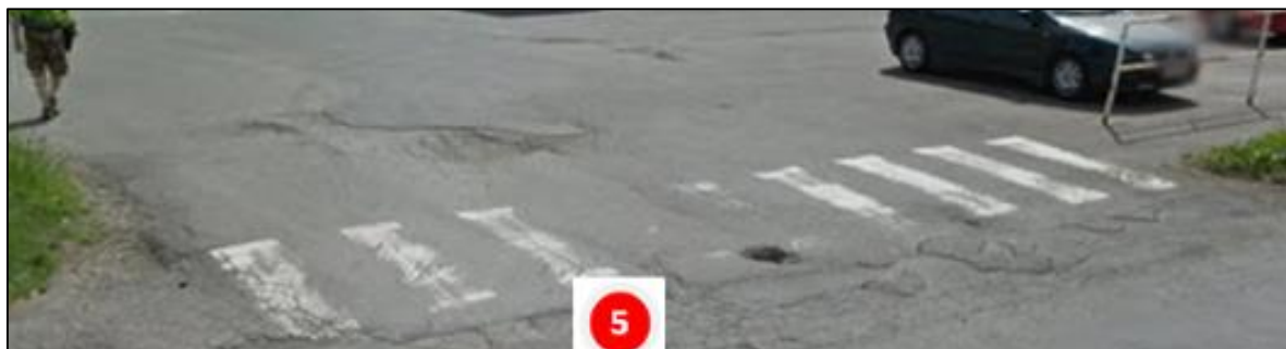
Obrázek 11 - Fotodokumentace nedostatku č. 5
