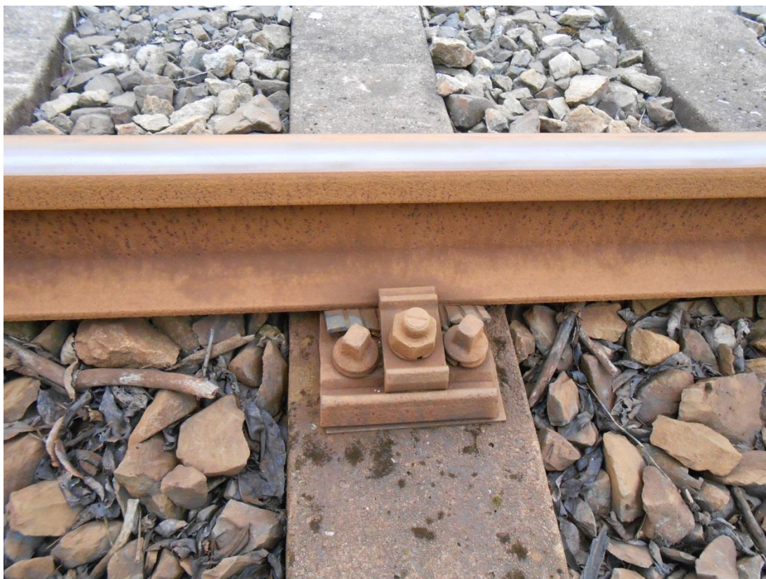
Obrázek 13 – Upevnění kolejnice S49 pomocí rozponového upevnění k pražci SB5 užitě v rámci trati
