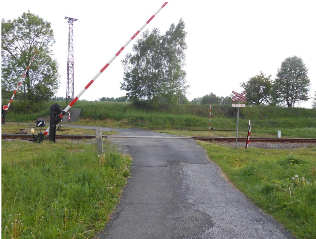
Obrázek 3 – PZZ - mechanické závory (druhý nejčastější způsob PZZ na trati)
