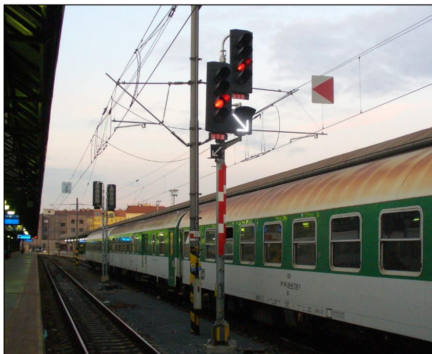
Obrázek 4. Cestová návěstidla dělicí staniční kolej v žst. Praha hl. n., zdroj: [13]
