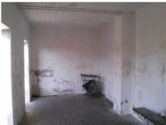
Obr. 10: Poničená železniční zastávka
