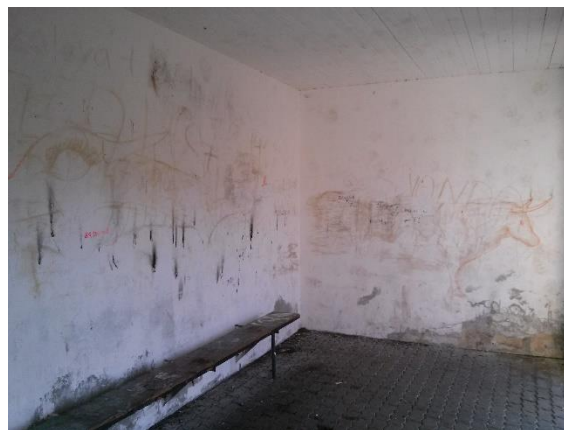
Obr. 11: Poničená železniční zastávka
