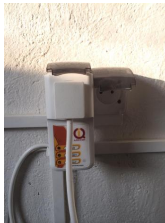
Obrázek 18: Elektrická zásuvka pro vzdálený restart přijímače kolejí [zdroj Ing. Martin Zach]
