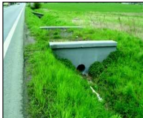
Obrázek 26: Nevyhovující propustek, zdroj: [21]
