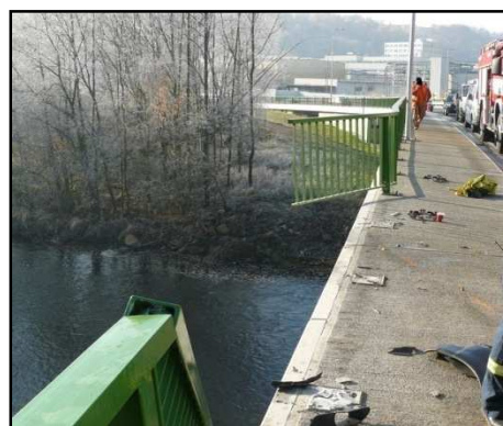
Obrázek 31: Proražené zábradlí na mostě, zdroj: [25]
