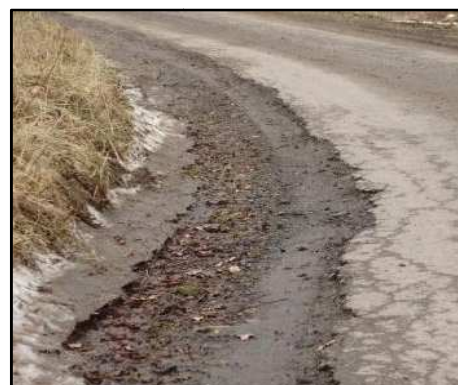
Obrázek 23: Poškozená krajnice, zdroj:[19]
