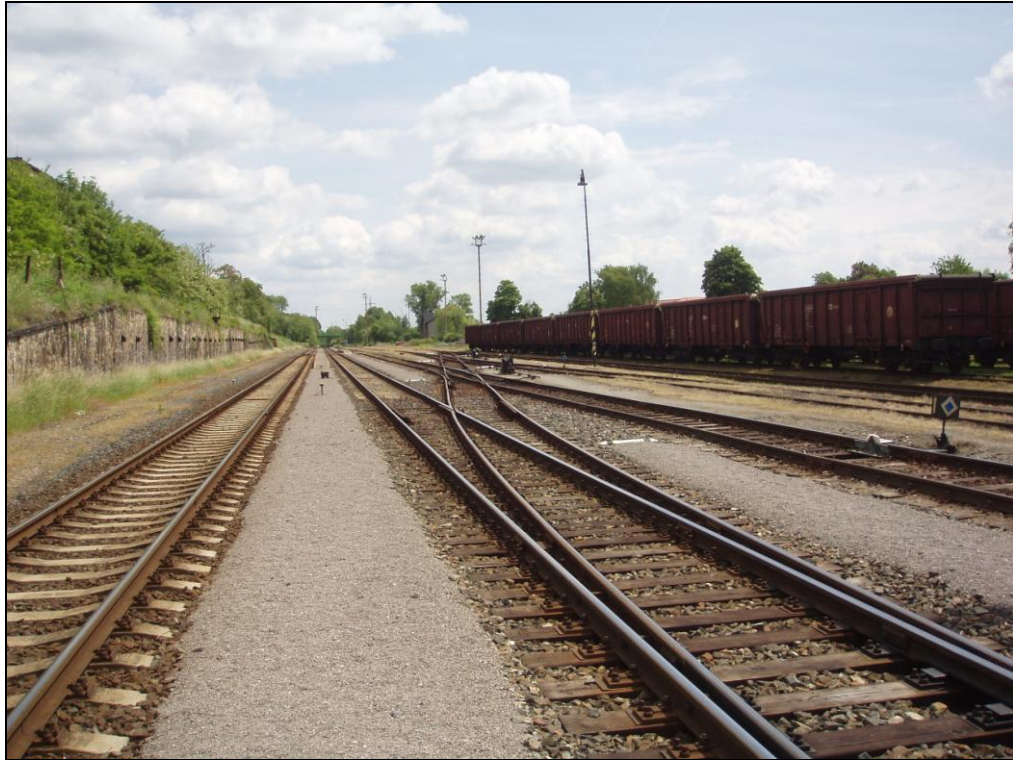
pohled na spojky dopravních kolejí
