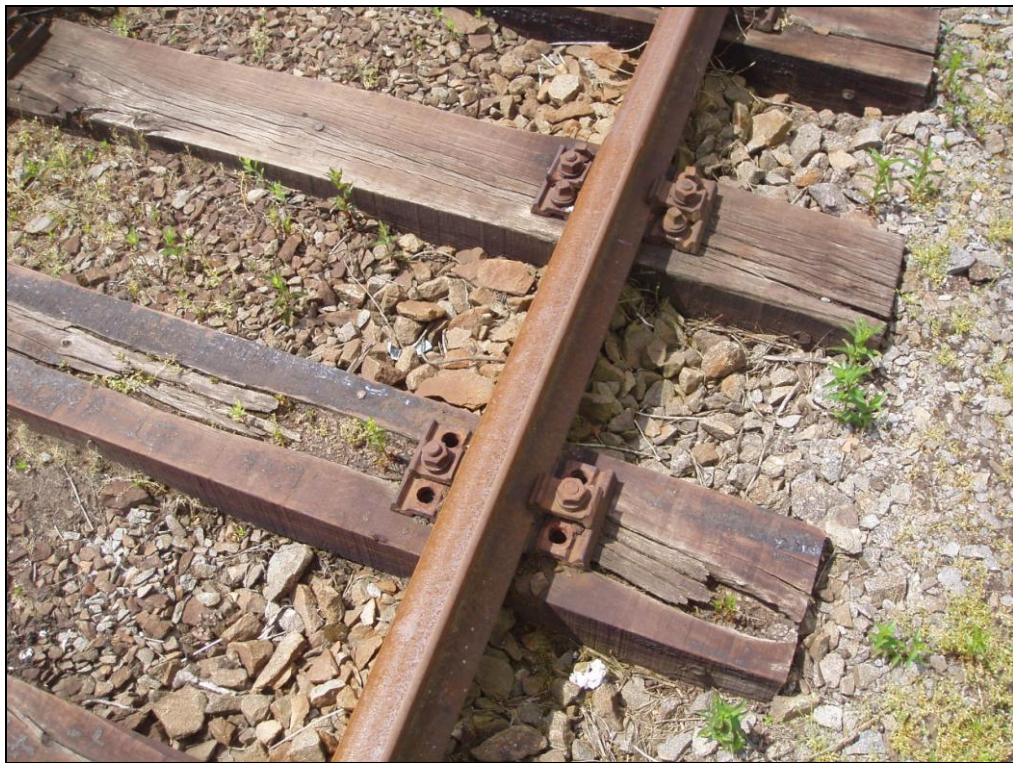
chybějící upevňovadla a dosluhující dřevěné prazce
