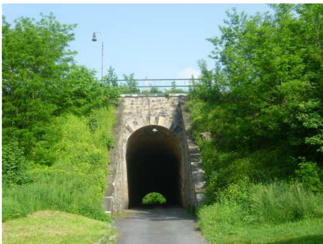
Foto 1: Jedna ze dvou komunikací, po níž je možné se dostat od centra města Hrob k železniční stanici Hrob
