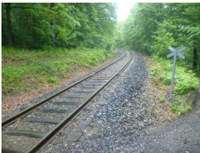
Foto 23: Přejezd v km 144,780, společně s přejezdem v km 145,331 jsou příčinou snížení rychlosti na 30 km/h; pohled ve směru staničení
