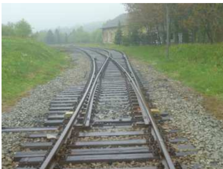
Foto 20: Mostecké zhlaví železniční stanice Moldava v Krušných horách; pohled ve směru staničení
