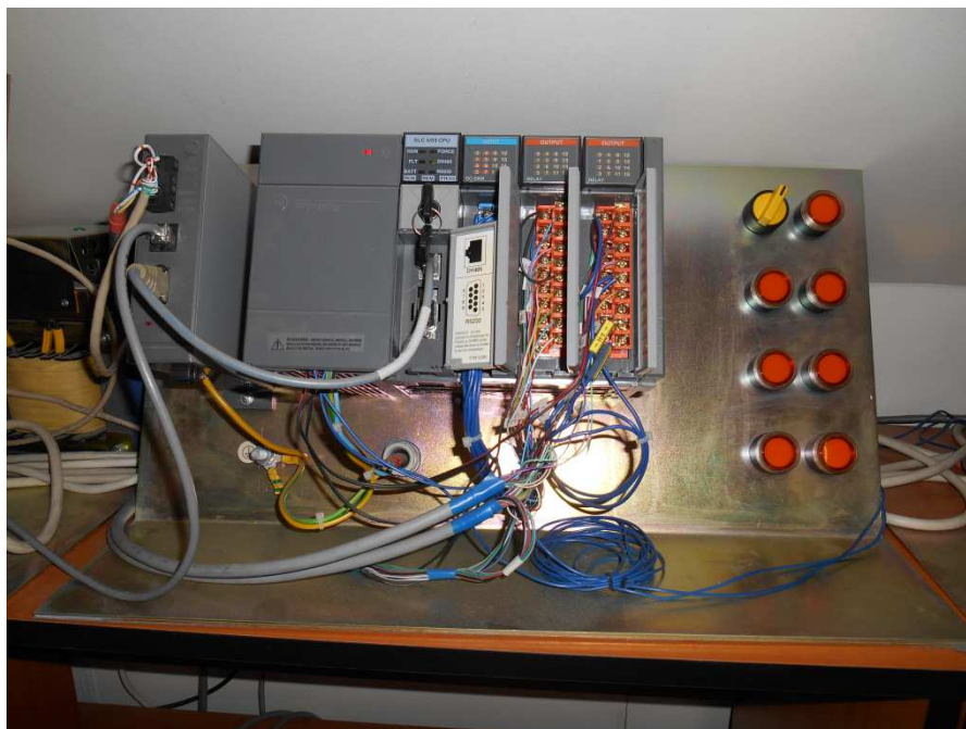
Obr. 21: Automat SLC 5-03, na němž byla provedena implementace
