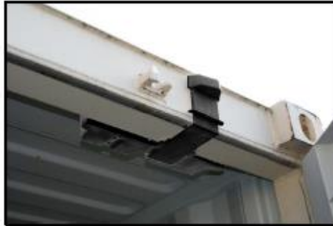
Obr. 45 CSD zařízení EDC76 nainstalované v kontejneru
