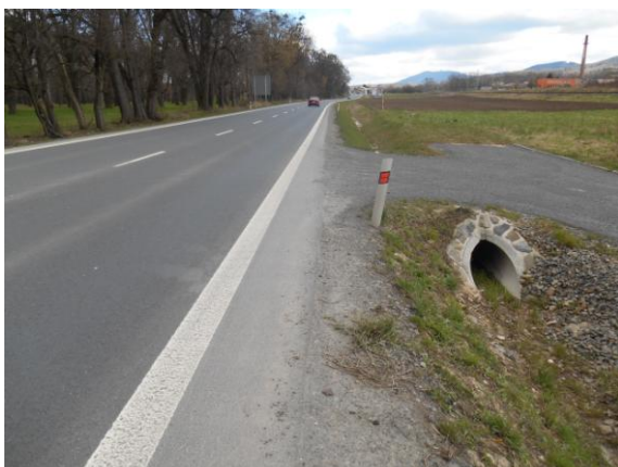
Obrázek 113 - Tuhé čelo propustku 1 (foto Sysala 2015)
