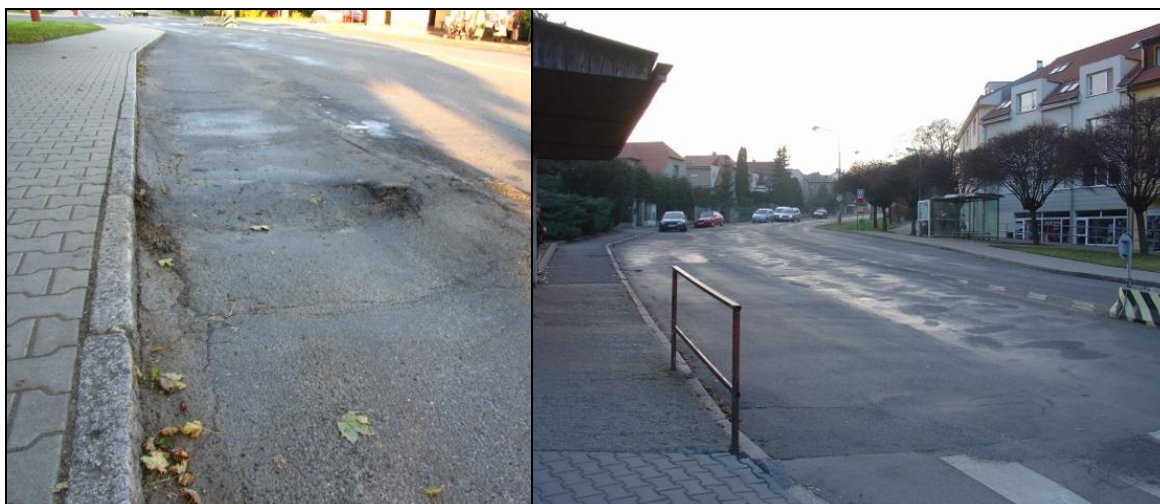
[obr.1] stav povrchu vozovky zastávkového zálivu od Prahy
