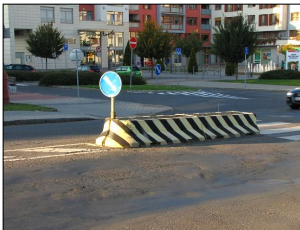
[obr.8] montované betonové ostrůvky šířky 1,00m; směrem do křižovatky chybí čelo ostrůvku chránící přechod Zdroj: fotoarchiv autora
