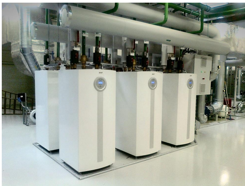
Obr. 5.2 - Kotelna s tepelnými čerpadly (BOSCH) [14]
