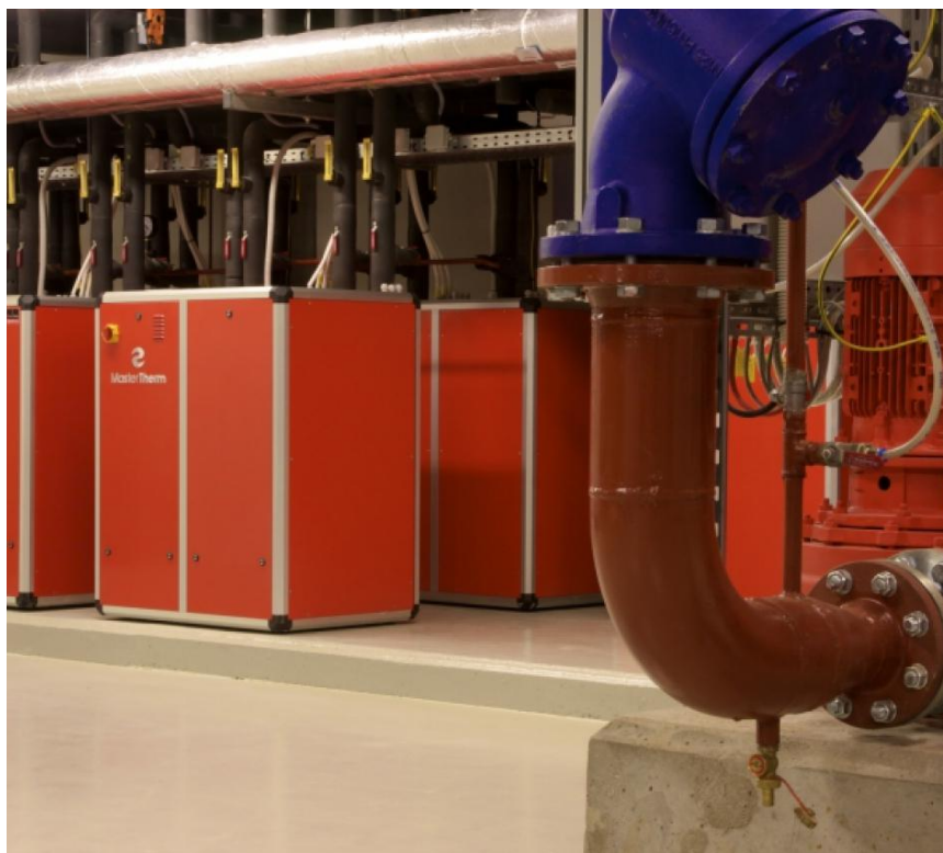
Obr. 5.3 - Kotelna s tepelnými čerpadly (HVM Plasma) [15]
