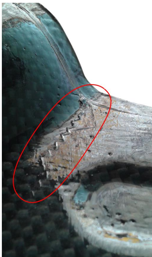
Obr. 54.: Detail vnitřního zaoblení s vyznačenou trhlinou.
