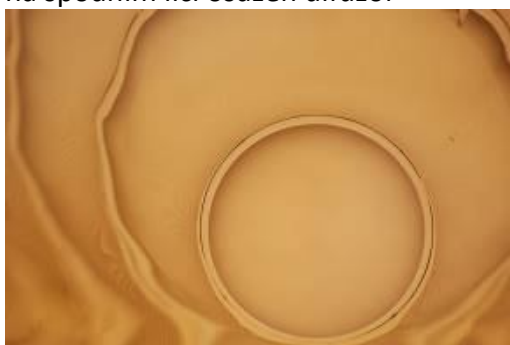
Obrázek 29: Pohled do světlovodu s odrazy světla na stěnách tubusu, na spodním líci osazen difuzor
