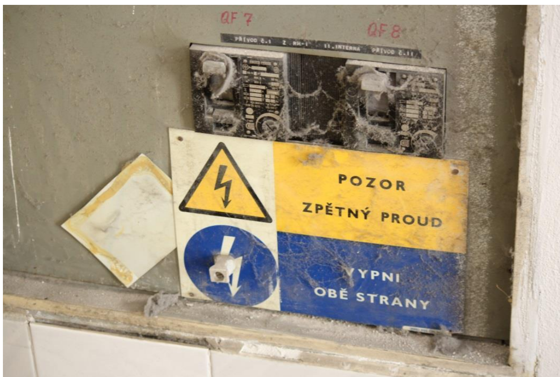
Obr. 5.1 znečištěný a nesprávně označený rozvaděč
