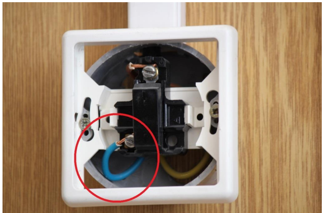
Obr. 5.4 Nesprávné zapojení vypínače
