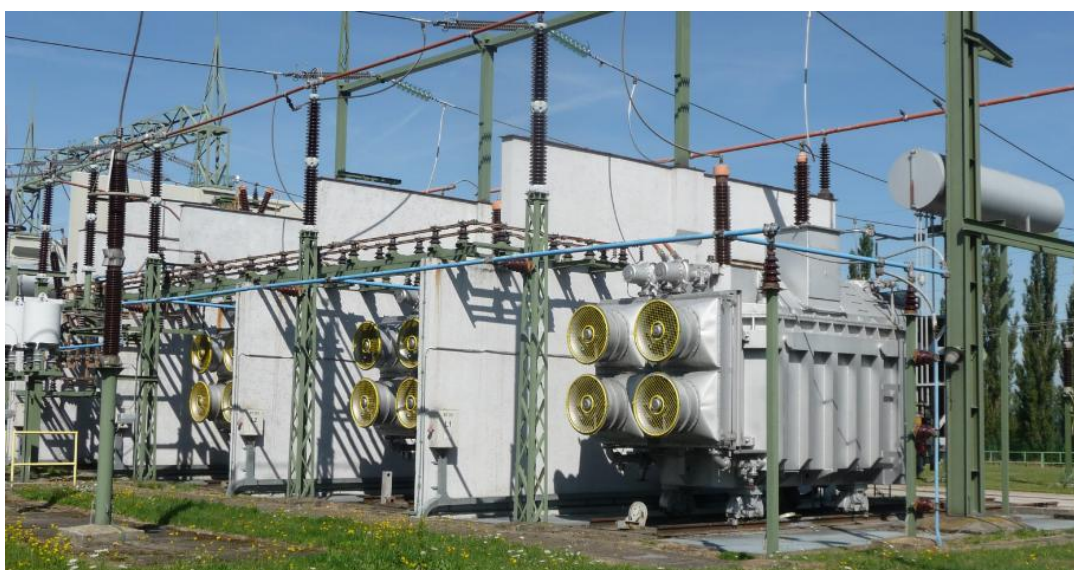
Obrázek 24: Autotransformátor Siemens 230/121kV (tři jednofázové jednotky)
