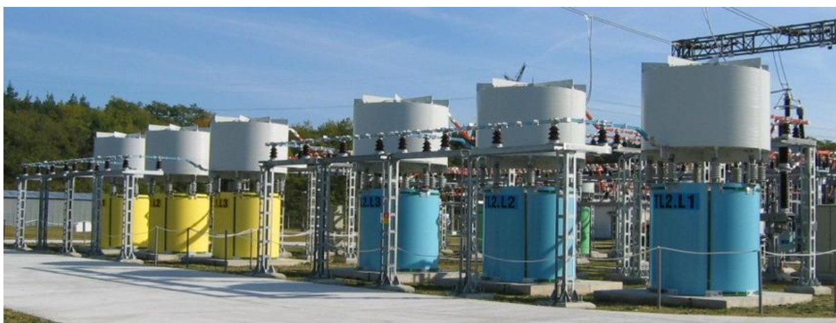
Obrázek 7: Kompenzační reaktory 2x45MVar, 10kV
