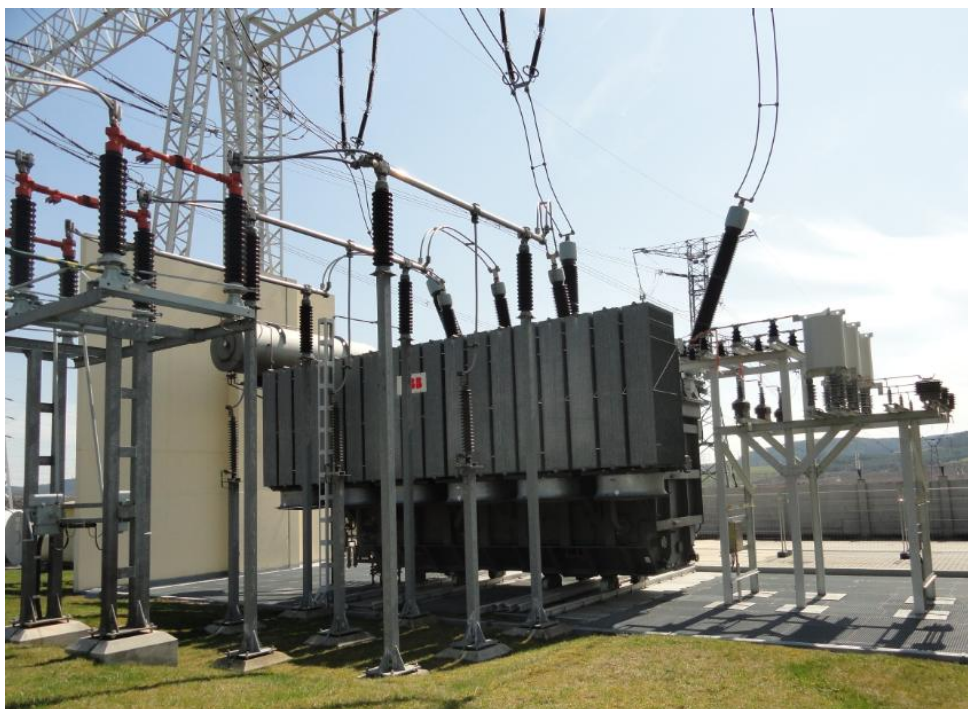
Obrázek 23: Autotransformátor ABB 400/121kV
