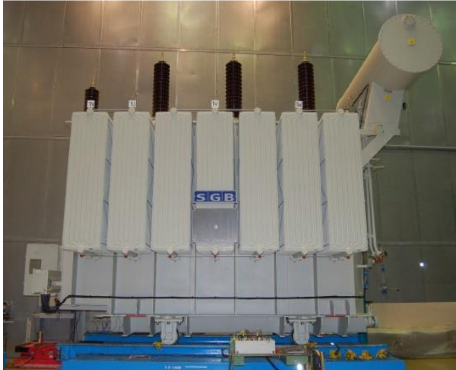
Obraz 12: Transformátor SGB 110/23 kV, 40 MVA, podle PREDi
