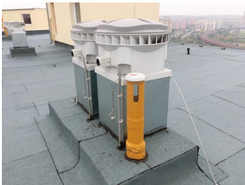
Obrázek 3 – Ventilátor odvětrávání [foto: vedoucí práce]
