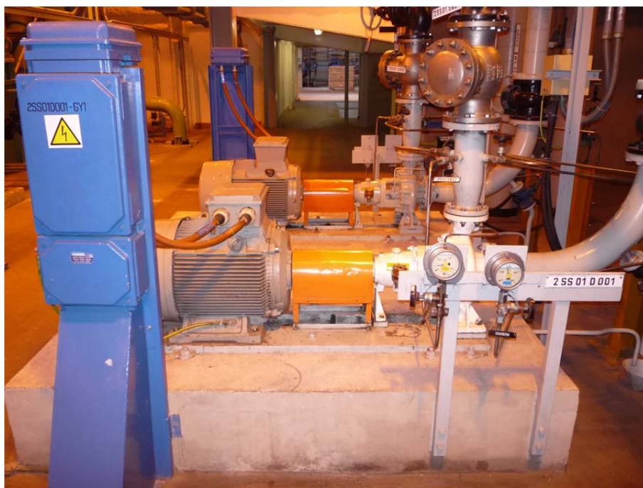
Obr. 6 Čerpadla statorové vody [ zdroj: vlastní zpracování ]
