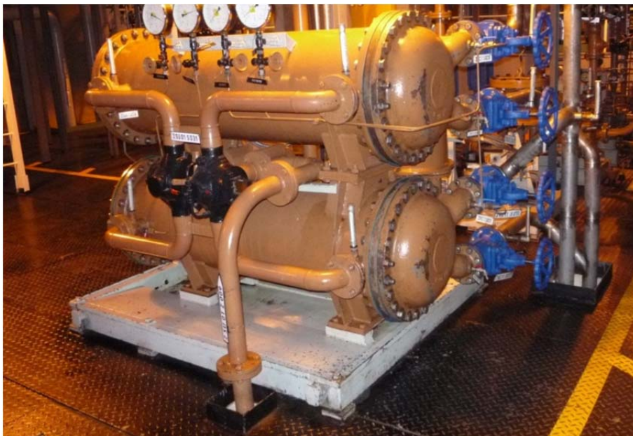
Obr. 13 Stávající chladiče těsnícího oleje (trubkové výměníky) [zdroj: vlastní zpracování]
