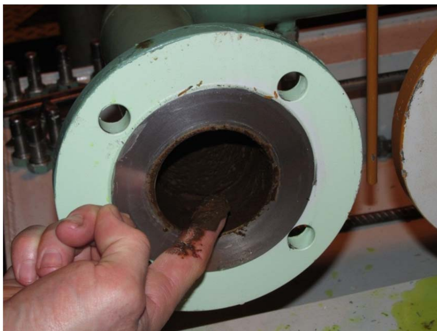
Obr. 39 Úsady v systému chladící vody – ilustrační foto [zdroj: vlastní zpracování]
