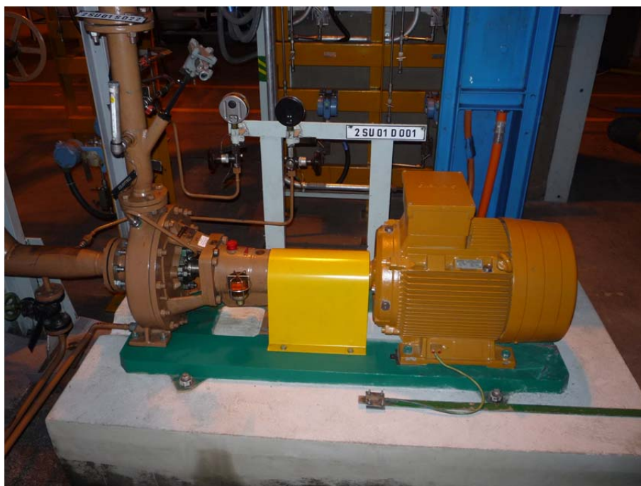
Obr. 10 Nouzové čerpadlo oleje na vodíkové straně ucpávek generátoru [zdroj: vlastní zpracování]
