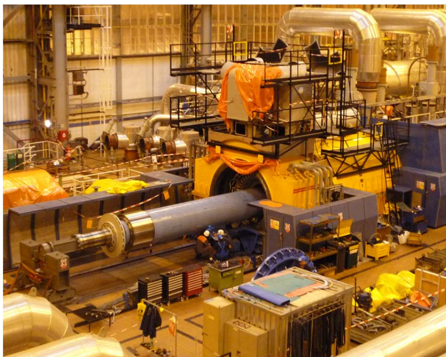
Obr. 3 Generátor v průběhu pravidelné revize [zdroj: vlastní zpracování]
