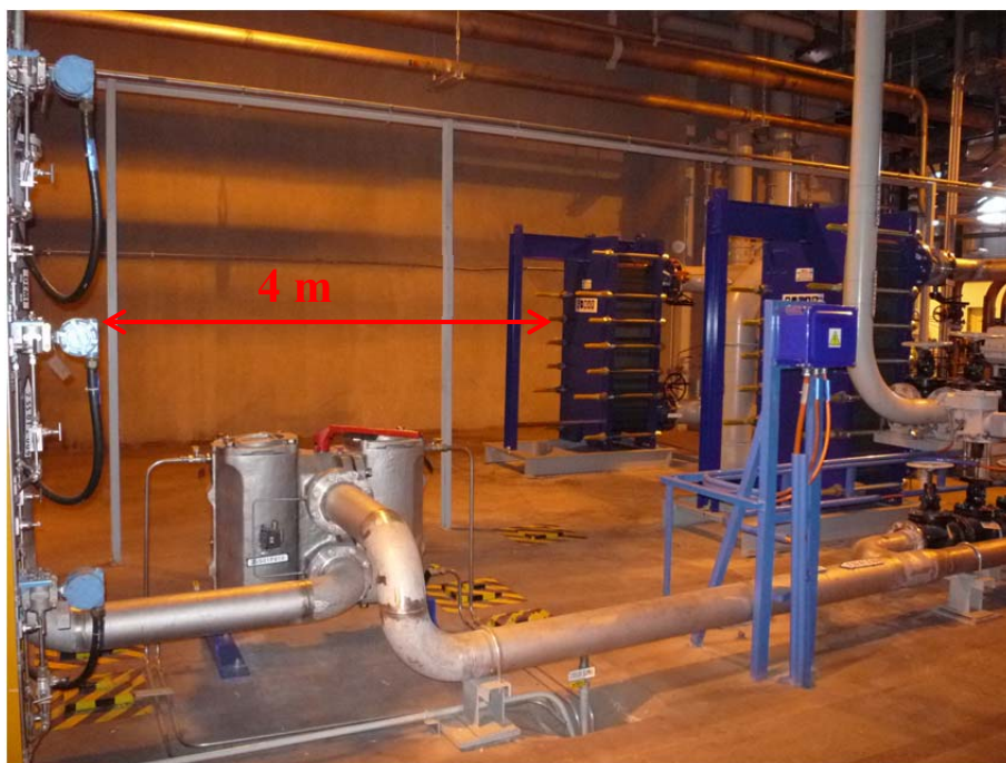
Obr. 1 Zkušenosti – použití deskových výměníků v systému chlazení satorové vody [zdroj: vlastní zpracování]
