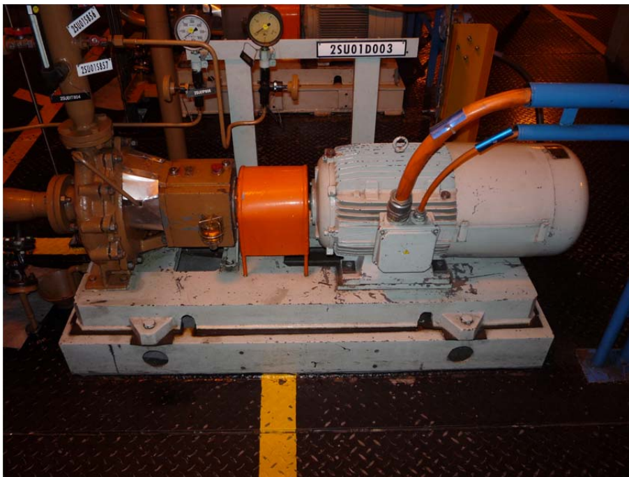
Obr. 12 Nouzové čerpadlo oleje na vodíkové straně ucpávek generátoru (ss motor) [zdroj: vlastní zpracování]
