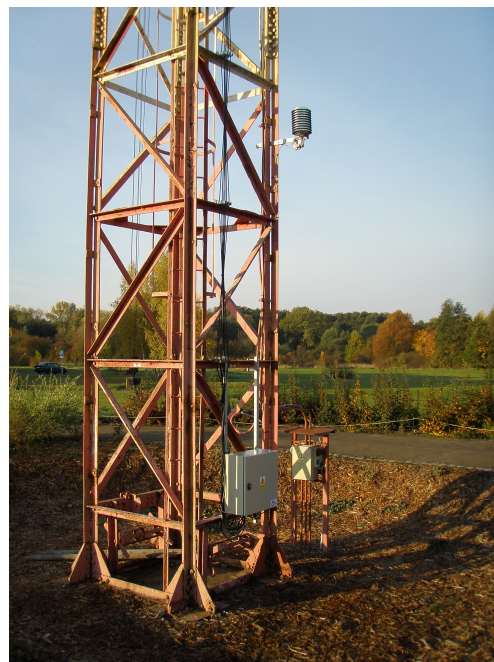
Obr. 6.4: Stožár Poděbrady - skříň se zařízením pro načítání dat a 1. čidlo teploty a vlhkosti
