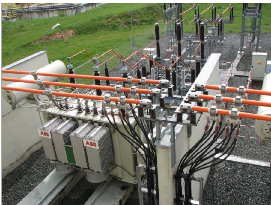
Obr. 5.2 Venkovní rozvodna 110 kV.
