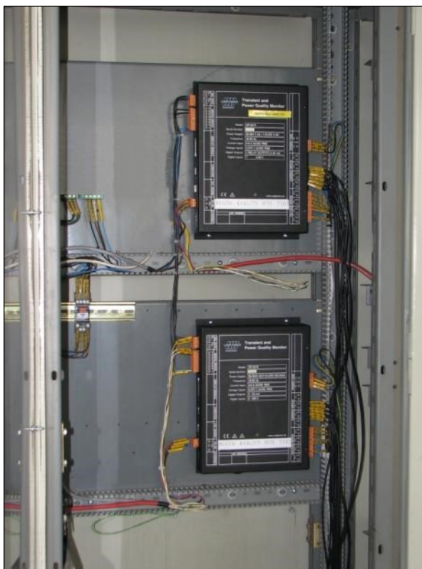
Obr. 7.2 Instalace stacionárních analyzátorů UNIPOWER UP-2210 na rozvodně 110 kV.
