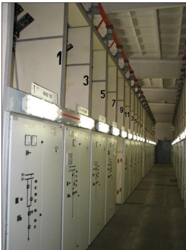
Obr. 5.3 Vnitřní rozvodna 6 kV.
