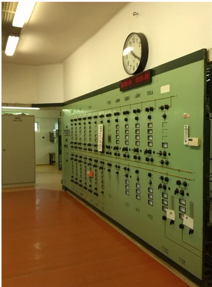
Obr. 4.11 – Velín rozvodny Tuchlovice
