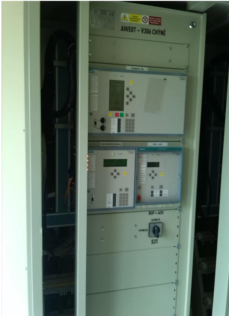
Obr. 4.5 - Distanční ochrana SIEMENS SIPROTEC pro vývod 110 kV (zde vývod „Chýně“)
