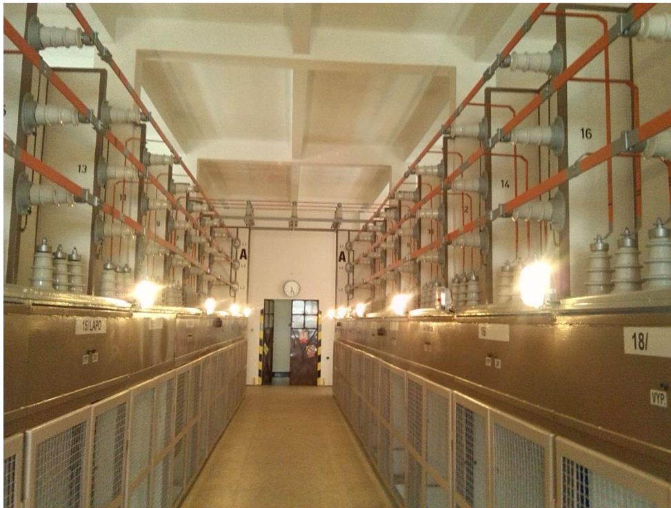
Obr. 4.10 – Připojnice ve druhém patře rozvodny 22 kV
