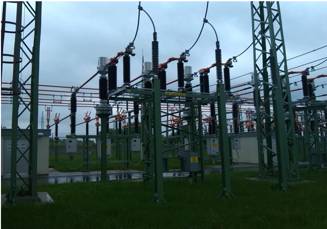
Obr. 4.3 – Venkovní rozvodna 110 kV Tuchlovice (odzadu – přípojnice, odpojovače, vypínač, měřicí transformátory napětí a proudu, vývodový odpojovač)
