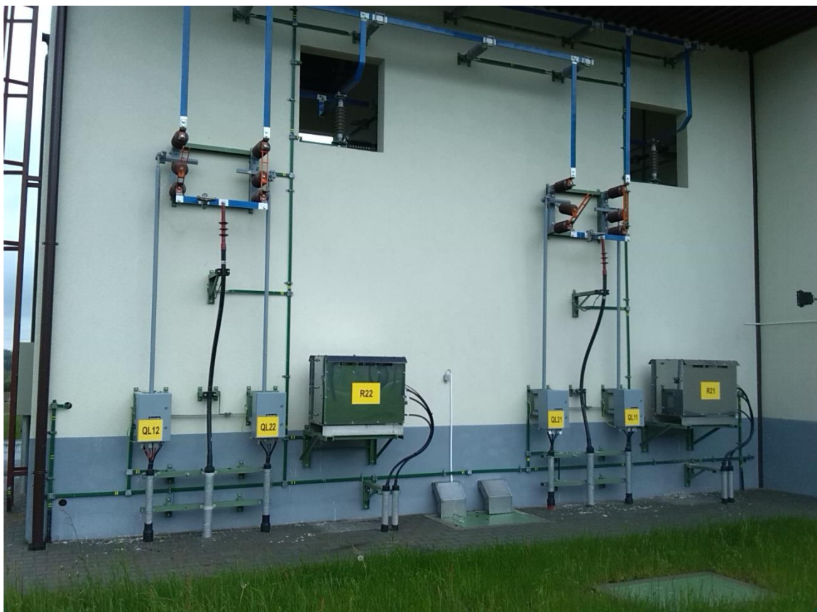
Obr. 4.8 – Pomocné odporníky (R22, R21) a odpojovače k zhášecím tlumivkám
