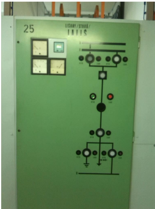
Obr. 4.9 – Ovládací panel pro odbočku „Lališ“ v prvním patře rozvodny 22 kV
