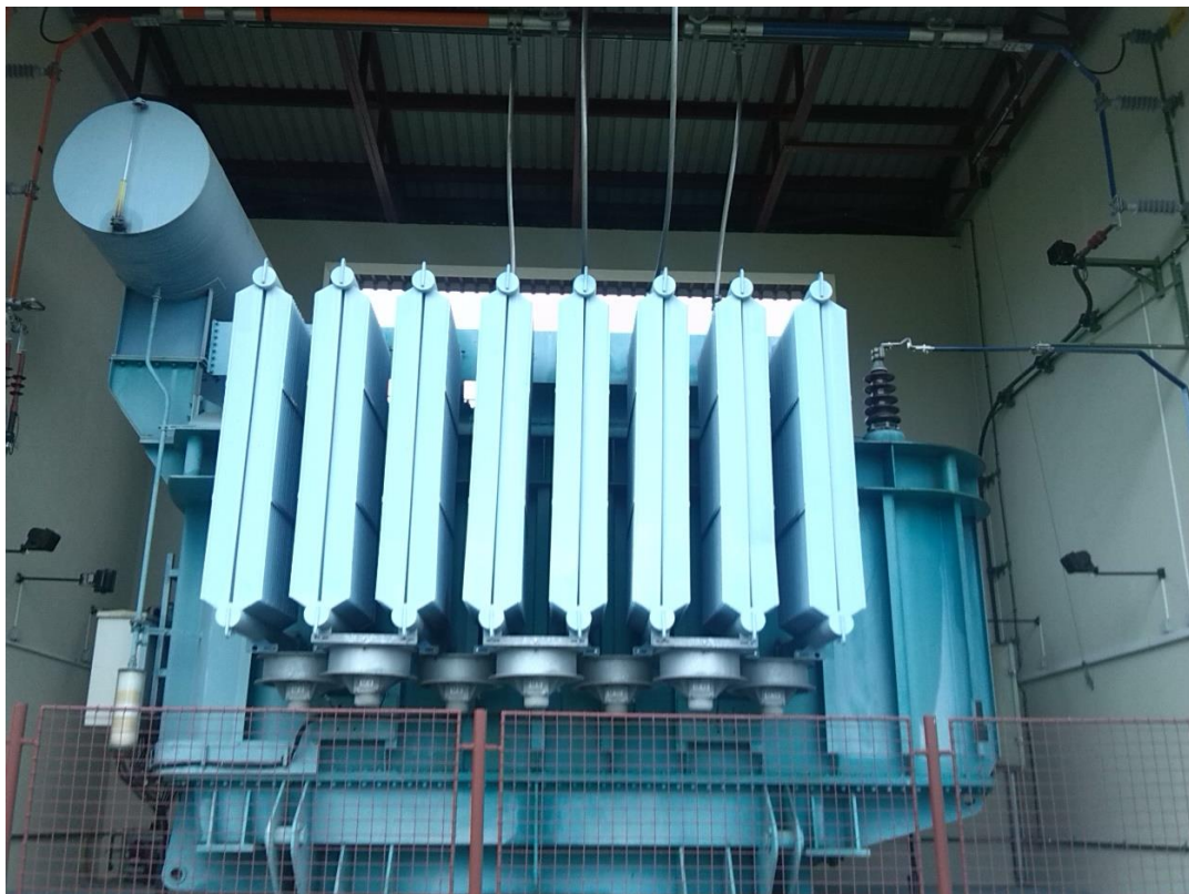
Obr. 4.2 – Měřený distribuční transformátor 110/23/6,3 kV YNyn0/(d)
